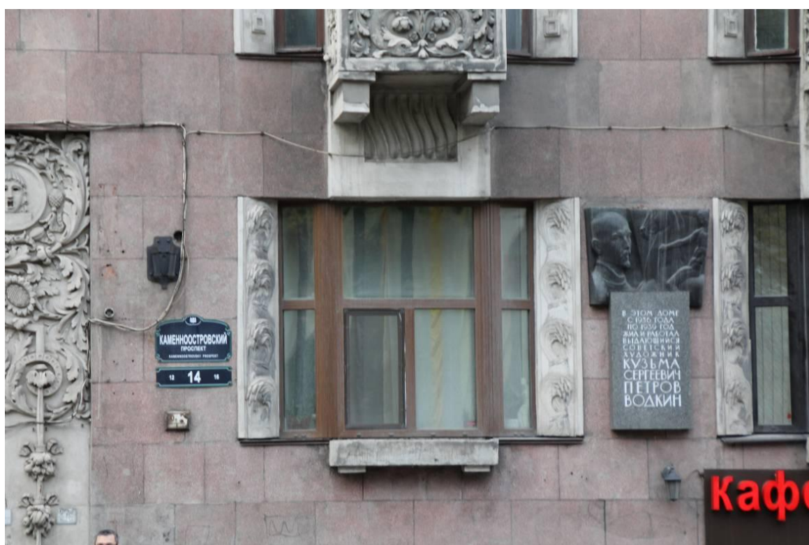
Рис. 6 Общее увлажнение, загрязнение, проявление сетки усадочных волосяных трещин на поверхности фасада. Деструкция штукатурного слоя. Увлажнение и загрязнение поверхности откосов, декоративных филенок и элементов балкона
