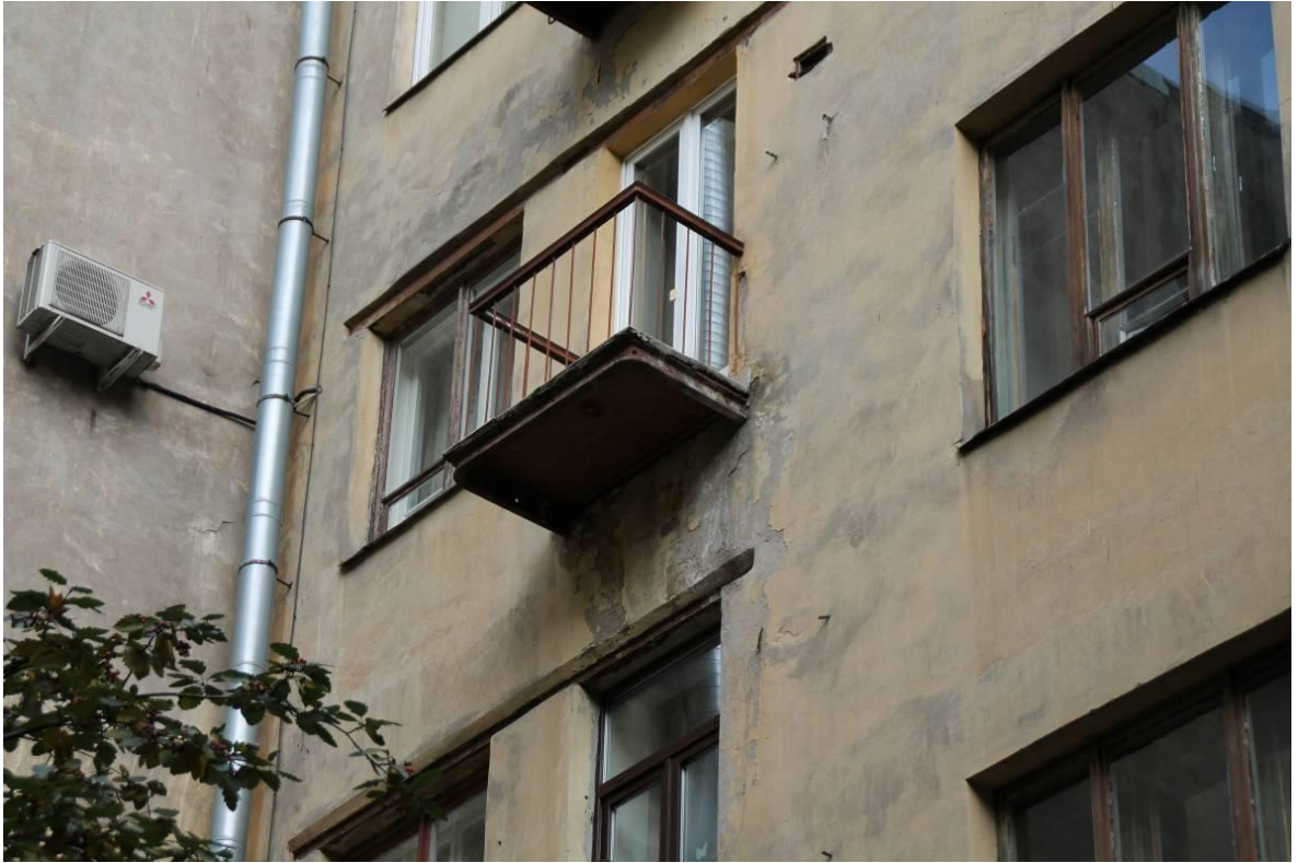
Рис. 9 Общее увлажнение, загрязнение, проявление сетки усадочных волосяных трещин на поверхности фасада. Деструкция штукатурного слоя. Коррозия металлических балок под балконной плитой. Повреждения балконной бетонной плиты и ограждения балкона.
