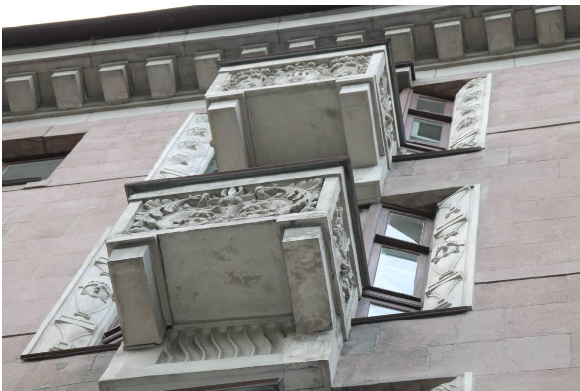
Рис. 5 Общее увлажнение, загрязнение, проявление сетки усадочных волосяных трещин на поверхности фасада. Деструкция штукатурного слоя. Увлажнение и загрязнение поверхности откосов, декоративных филенок и элементов балкона.
