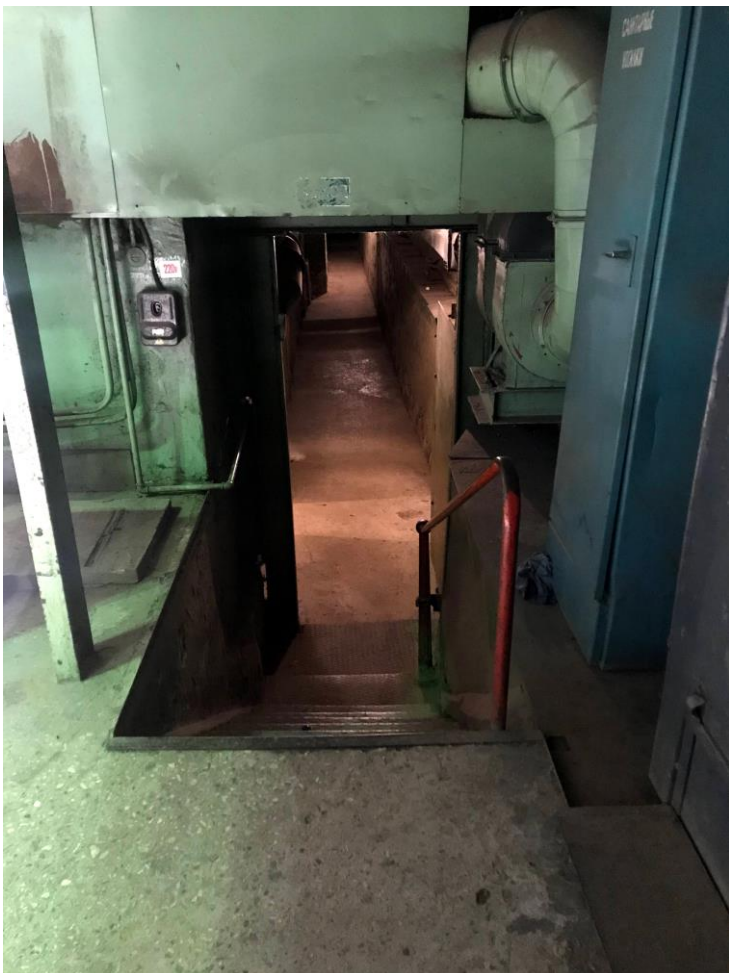
Фото 26. Вход в подвальное помещение пристроенного здания – место утраты кладки фундамента демонтированной торцевой стены.
