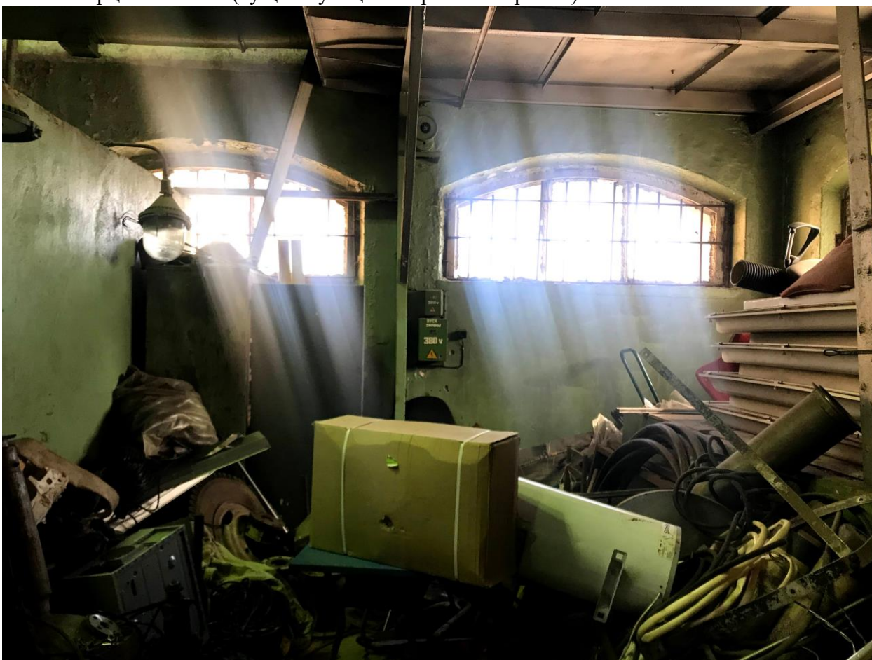
Фото 20. Заложенные окна на лицевом фасаде производственного объема объекта культурного наследия.
