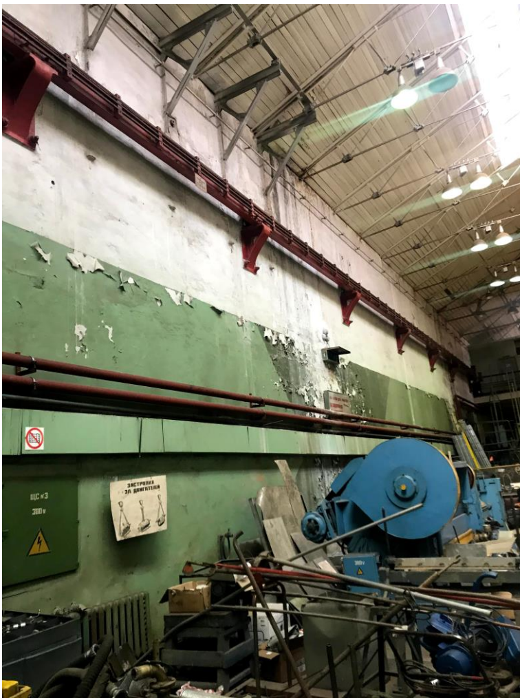
Фото 23. Западная стена производственного объема объекта культурного наследия. Вид со стороны помещения. На стене расположена подкрановая балка.
