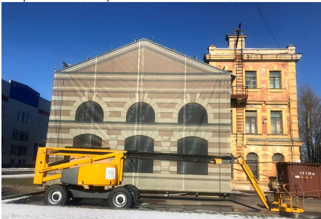
Фото 2. Торцевой фасад объекта культурного наследия регионального значения «Главная электрическая станция Обуховского сталелитейного завода»
