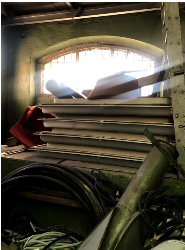
Фото 21. Заложенные окна на торцевом фасаде производственного объема объекта культурного наследия.
