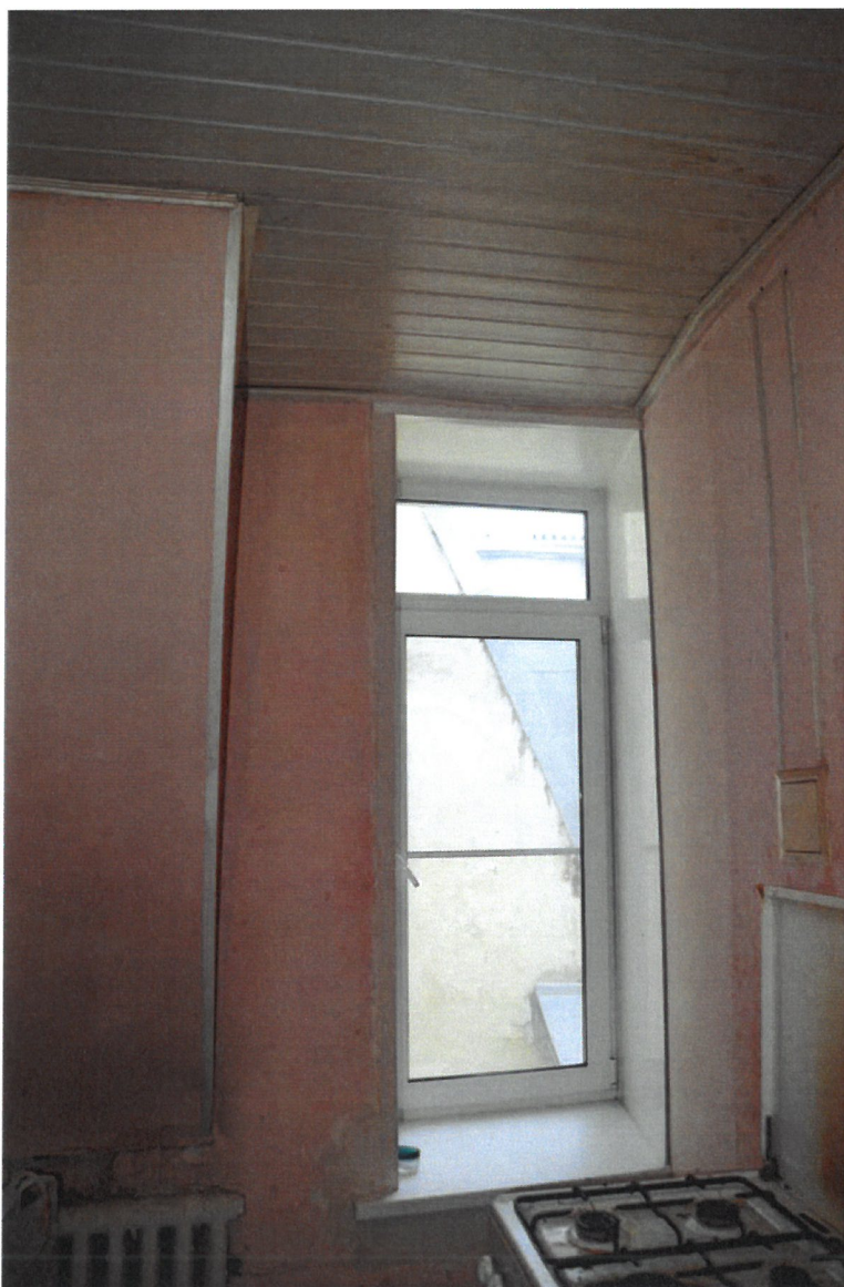
15. Выявленный объект культурного наследия «Дом И.Я.Романова» (Санкт-Петербург, 10-я Советская ул., д.19). Кухня кв. № 87. Одностворчатое окно и зашитая конструкция крыши.
