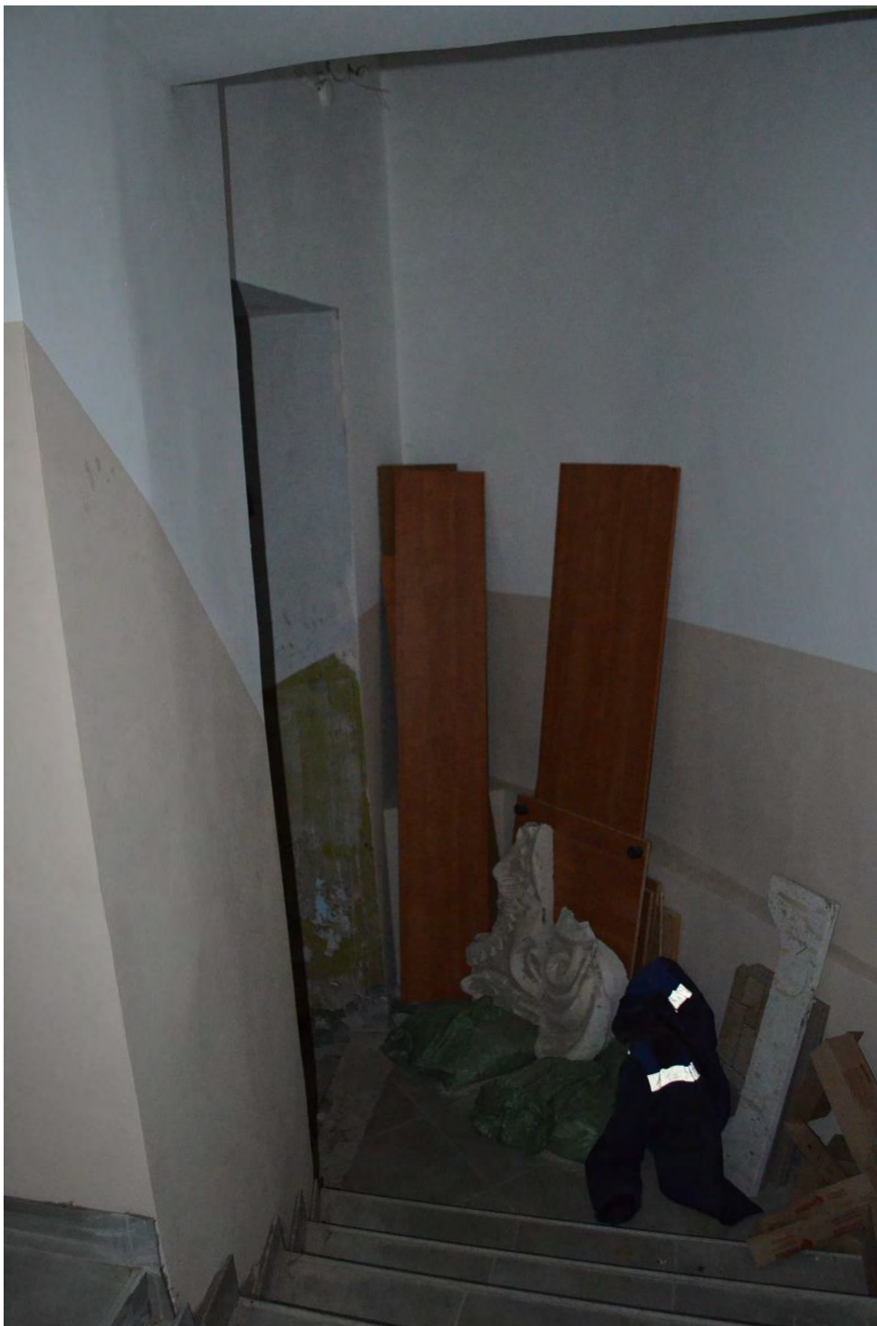
Фото 52. ОКН федерального значения «Церковь святого князя Феодора Новгородского». Помещение первого этажа. Вход в подвальные помещения. Съёмка 10.11.2021 г.
