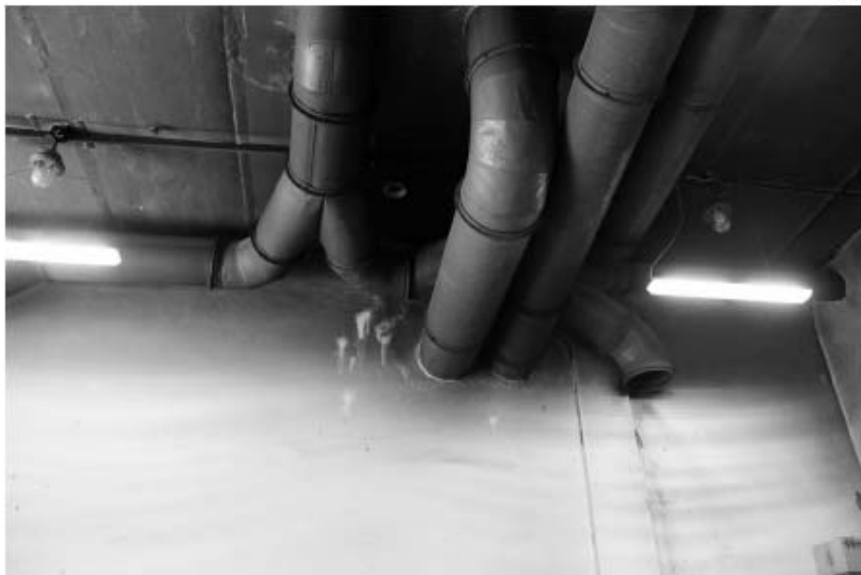
Фото № 21. Инженерные сети пом. 6 здания по Кожевенной лин. № 39 корп. 8.
