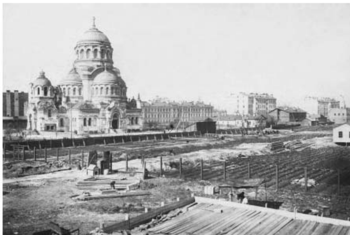
Илл. 26. Территория завода «Севкабель» (В.О., Кожевенная линия, д.39). Церковь Милующей иконы Божией Матери. 1907 – 1913 гг. Электронный портал pastvu.com .
