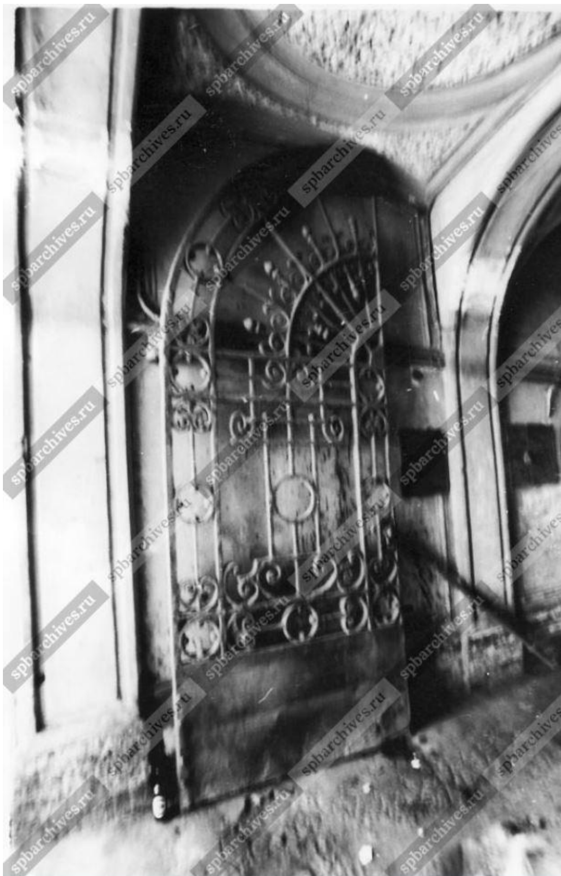
23. Вид створки ворот в арочном проезде дома № 26 на Загородном проспекте, 2004 г. - ЦГАКФФД СПб. Фотодокумент Ар 225626
