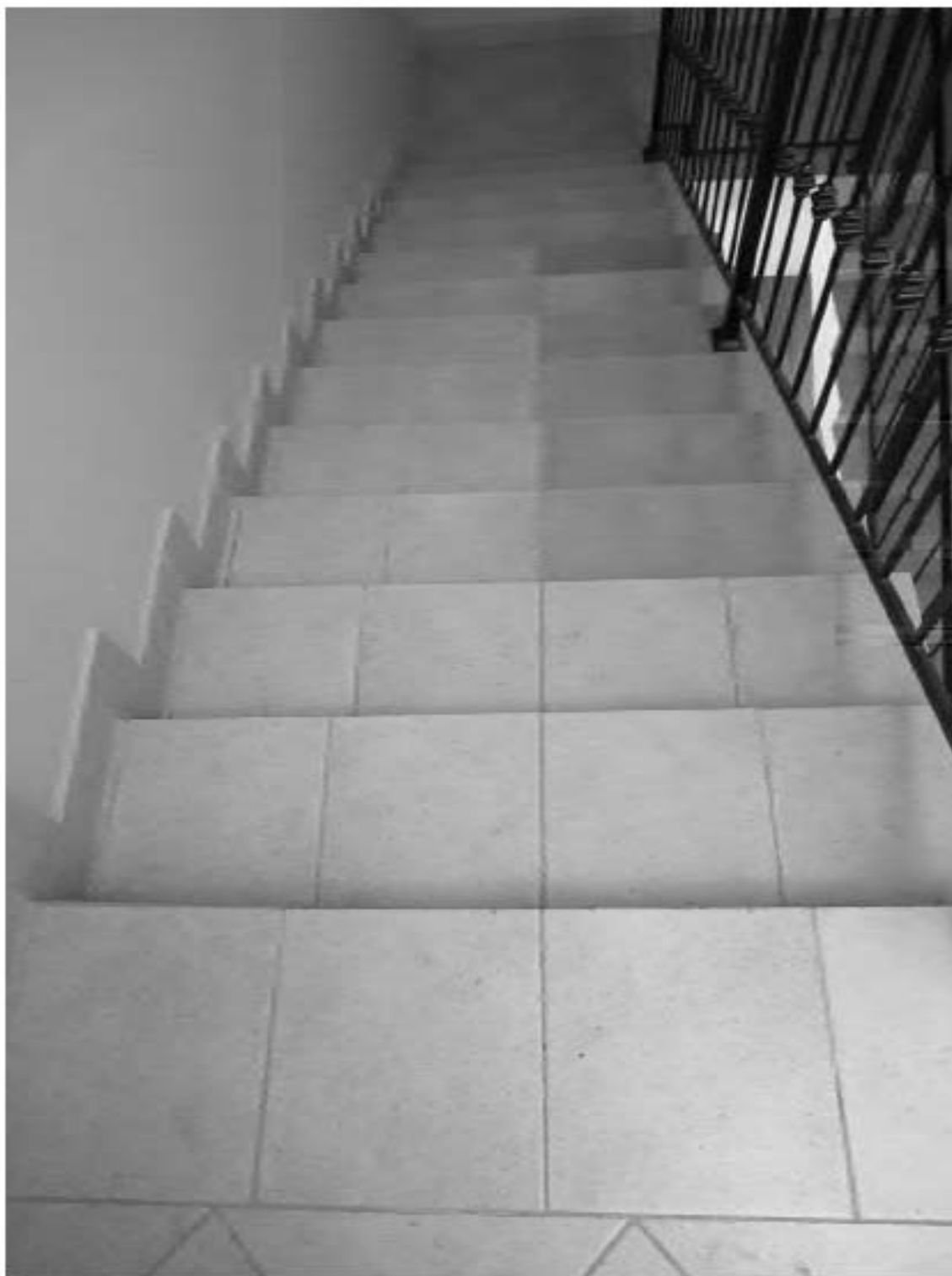
2. ОКН "Усадьба Военного министра", расположенный по адресу: г. Санкт-Петербург, ул. Садовая, д. 4, лит. А. Лестница служебного флигеля. Дата фотофиксации: 17.11.2021
