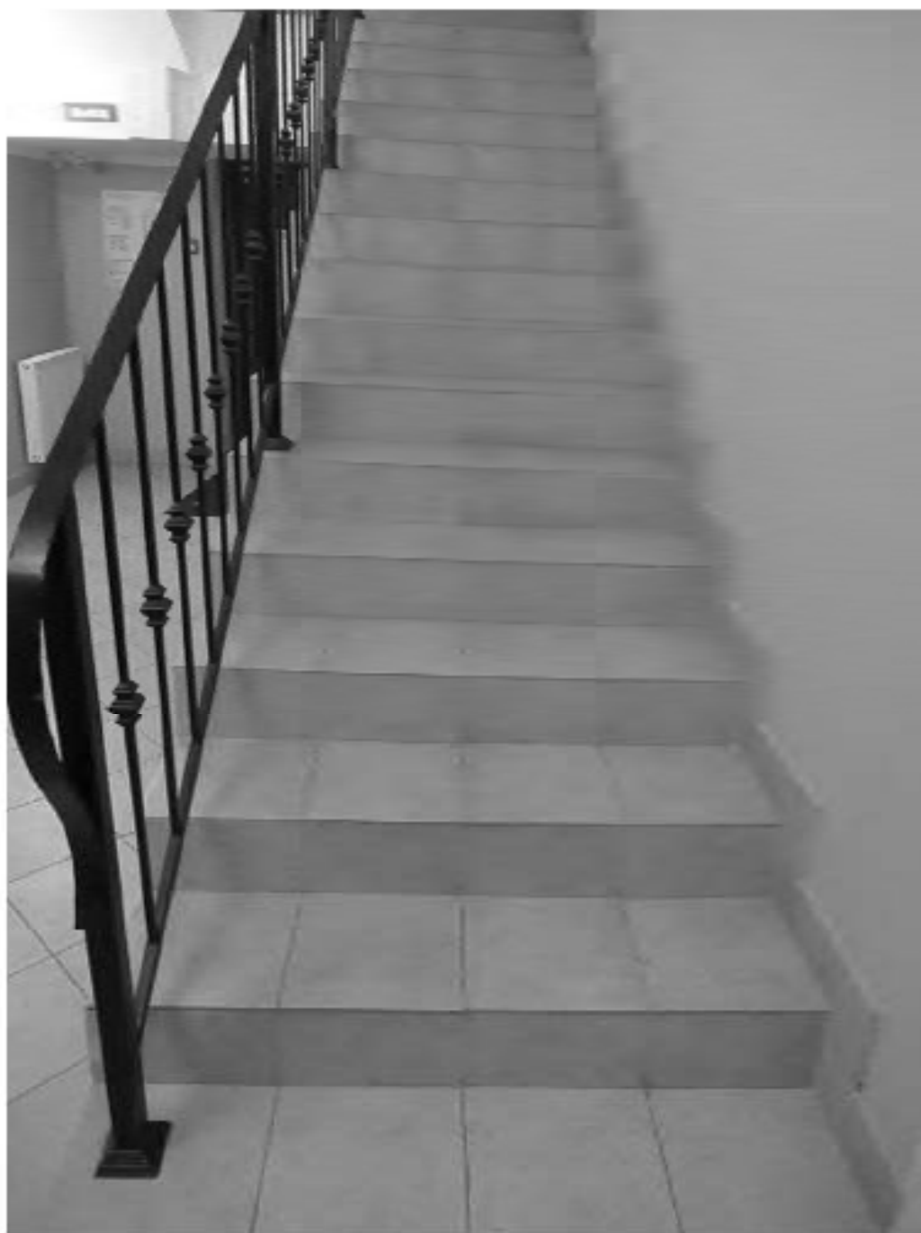
2. ОКН "Усадьба Военного министра", расположенный по адресу: г. Санкт-Петербург, ул. Садовая, д. 4, лит. А. Лестница служебного флигеля. Дата фотофиксации: 17.11.2021
