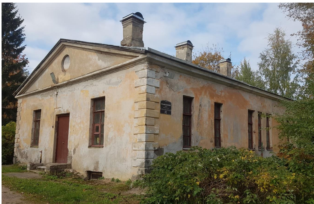
Фото 2. Фасад в осях 11-12, фасад в осях А-Д.
