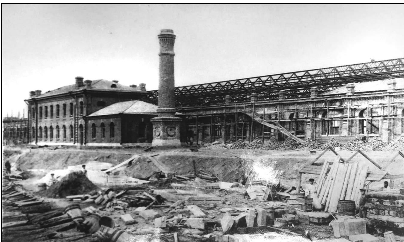
Илл. 17. «Общий вид сарая для Императорских поездов и пристройки к нему. Приготовление цементно-бетонных облицовочных камней». 1897 – 1898 гг.
