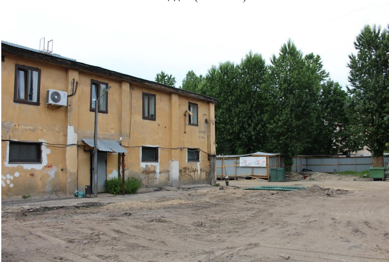
Фото 10. Вид на дворовый корпус (литера А1) и территорию строительной площадки с юго-востока.
