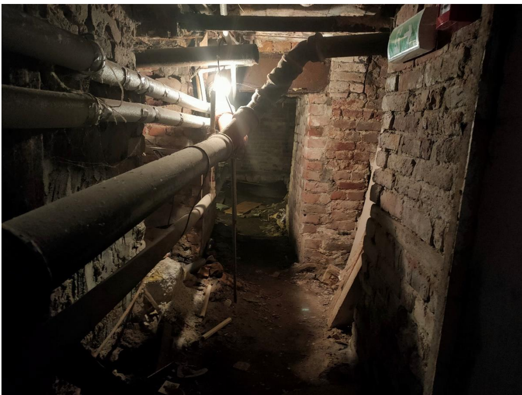
19. «Особняк Штифтер», ул. Моховая, д.15, лит. А. Подвал. Общий вид. Фото 22.07.2022г.
