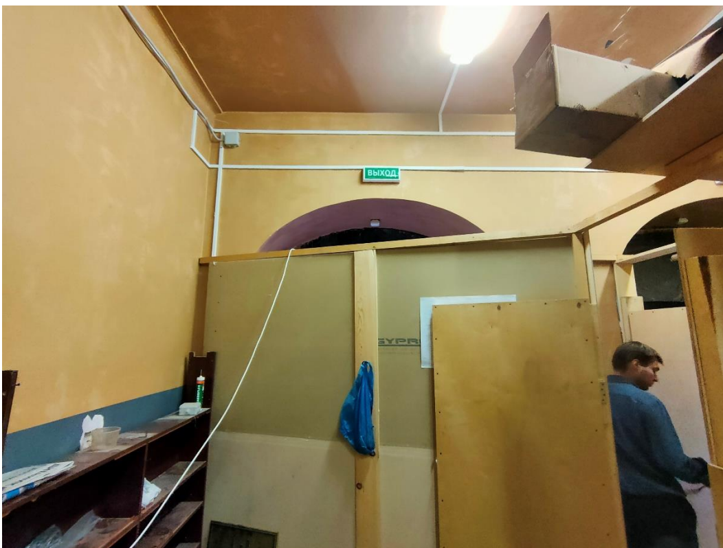
5. «Особняк Штифтер», ул. Моховая, д.15, лит. А. Первый этаж. Помещение №1. Общий вид. Фото 22.07.2022г.
