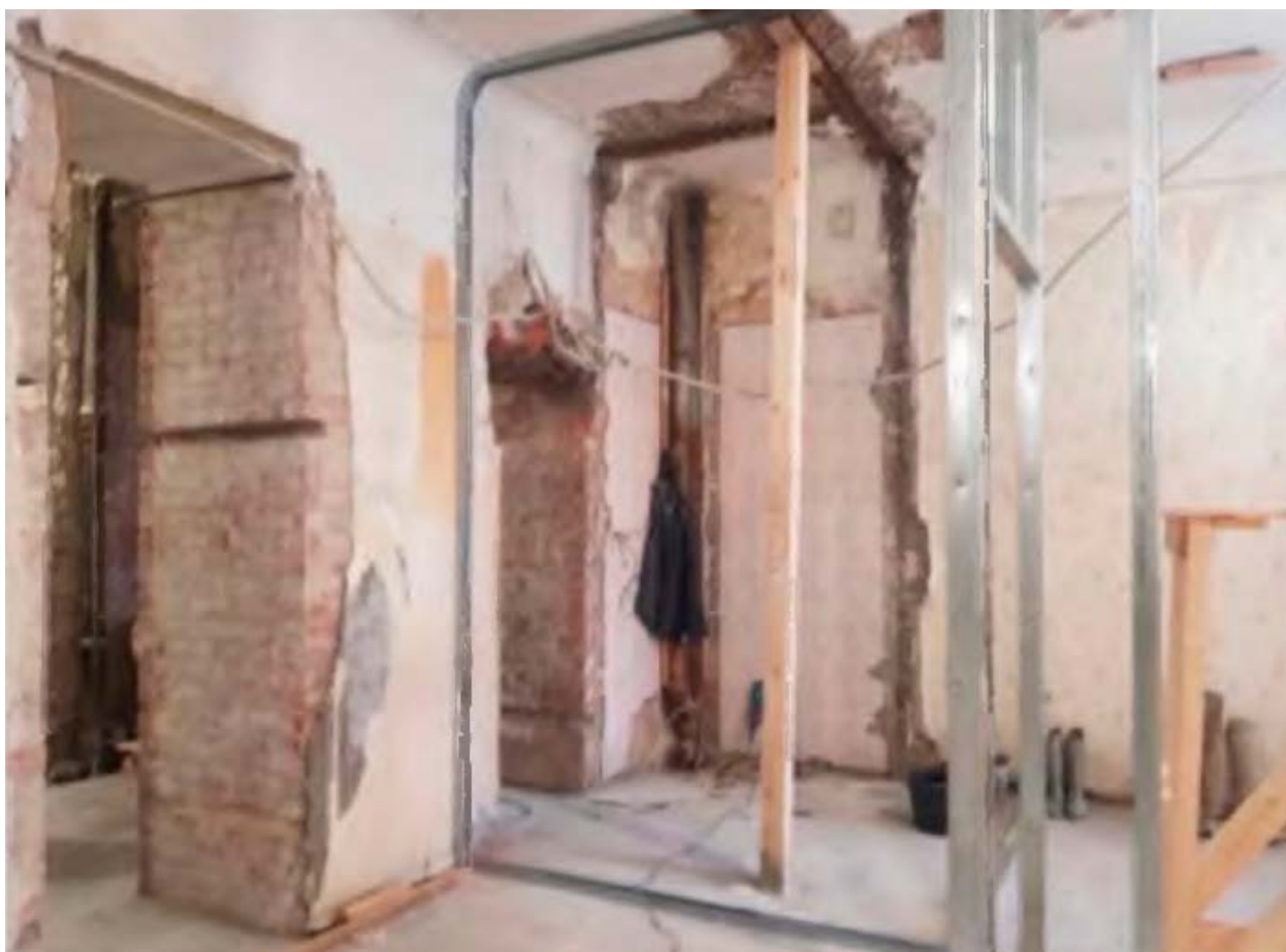
5. Помещение №6 квартиры №72 в уровне 2-го этажа объекта культурного наследия регионального значения «Дом, где в 1917 г. жил Джон Рид», расположенного по адресу: г. Санкт-Петербург, ул. Рубинштейна, д. 23, литера А. 10.09.2021.
