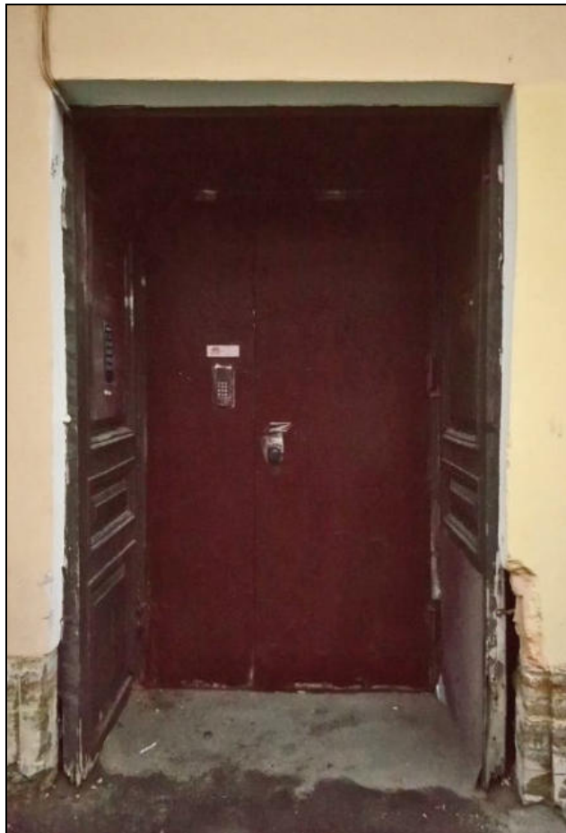
26. Лицевой фасад «Дома по проспекту». Современное заполнение дверного проема первого этажа по 4-й оси (вход в подъезд). Наружные двери утрачены. На откосах проема сохранились деревянные филеатые панели тамбура. Дата съемки: 15 ноября 2021 г. Фотограф: Г. В. Михайловская.
