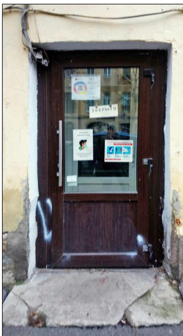
18. Лицевой фасад «Углового дома» по 6-й линии В.О. Современное заполнение дверного проема первого этажа по 9-й оси. Дата съемки: 15 ноября 2021 г. Фотограф: Г. В. Михайловская.
