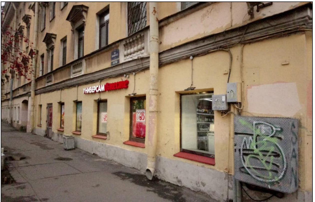
19. Лицевой фасад «Углового дома» по 6-й линии В.О. Современное заполнение дверных и оконных проемов первого этажа (по 14–21-й осям). Дата съемки: 15 ноября 2021 г. Фотограф: Г. В. Михайловская.
