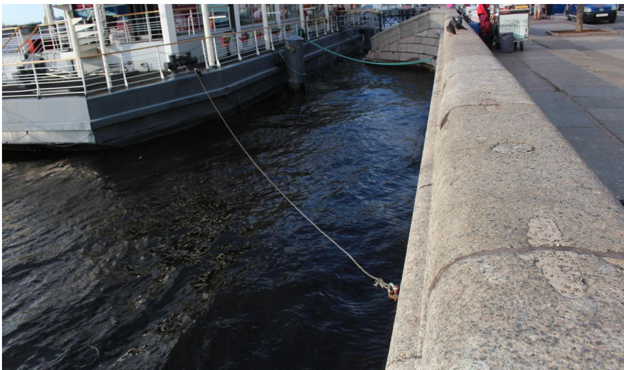
Фото 3. Вид на крепление дебаркадера к рьям.
