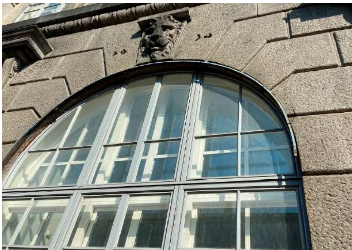
5. Юго-восточный лицевой фасад по улице Почтамтской объекта культурного наследия регионального значения «Здание Управления городского телефона и телеграфа», расположенного по адресу: г. Санкт-Петербург, Почтамтская ул., 15, литера Б. Фрагмент. 15.08.2021.
