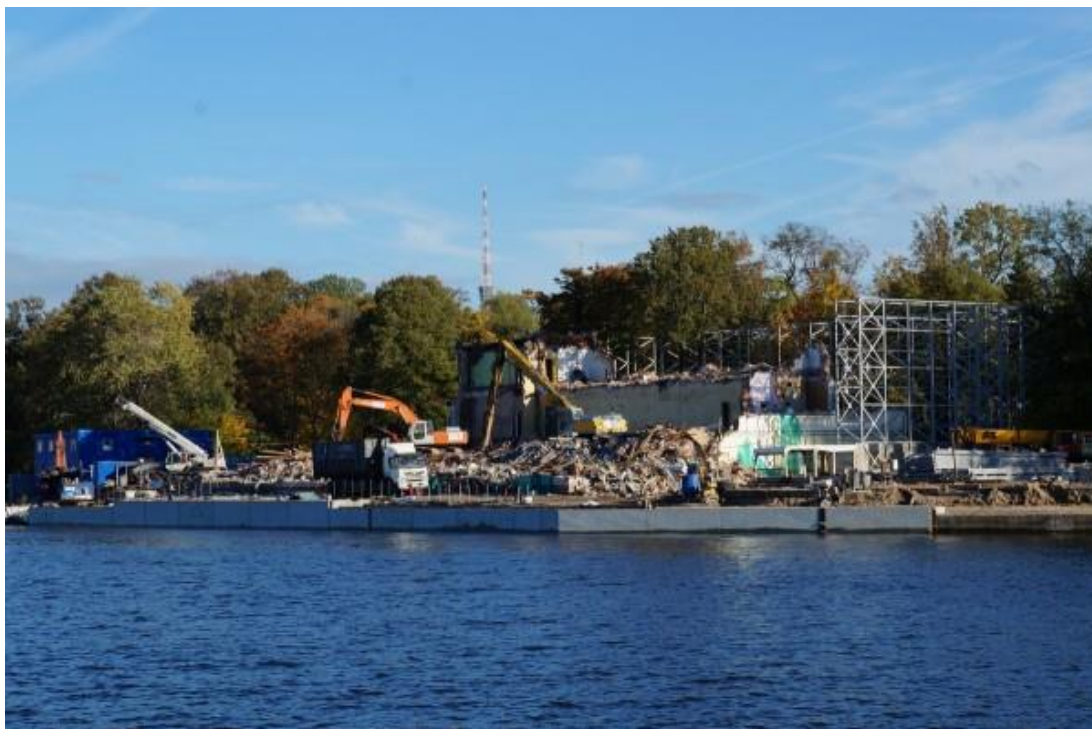
13. Объект культурного наследия регионального значения «Ресторан Кюба» на Каменном острове (Санкт-Петербург, набережная реки Большой Невки, дом 24, литера А (наб. р. Большой Невки, 24)). Работы по реконструкции 2015 г. Вид с Большой Невки. Фотография. https://www.citywalls.ru/
