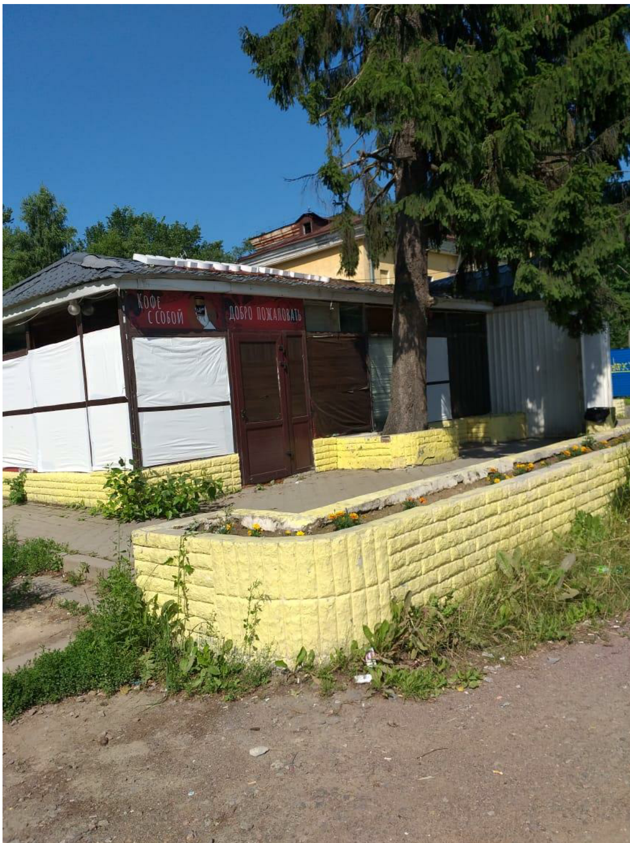
Фото 5. СПб, Осиновая Роща, Приозерское шоссе, дом 15, корп. 6. Лицевой фасад по Приозерскому шоссе. Фрагмент
