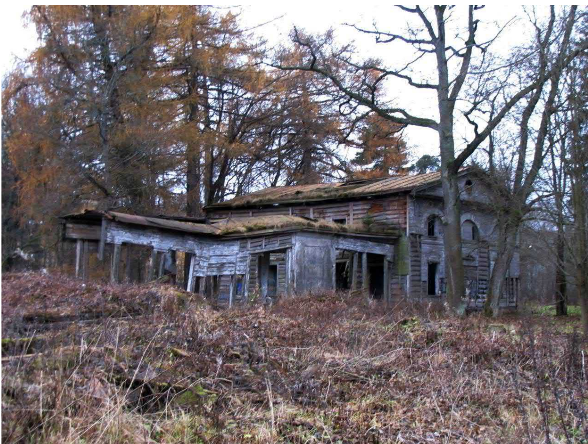
23. Современное состояние Усадьбы Вяземских (после пожара)
