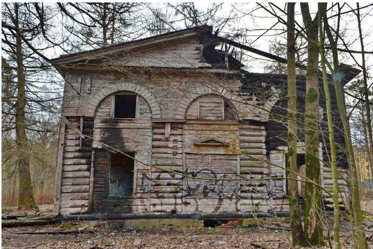
24. Современное состояние Усадьбы Вяземских (после пожара)
