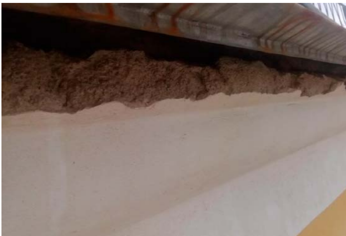
8. Фрагмент венчающего карниза дворового юго-западного фасада объекта культурного наследия регионального значения «Дом Балашова А.Д. (Стенбок-Фермора)», расположенного по адресу: г. Санкт-Петербург, Макарова наб., д. 26, литера А. 17.06.2022.
