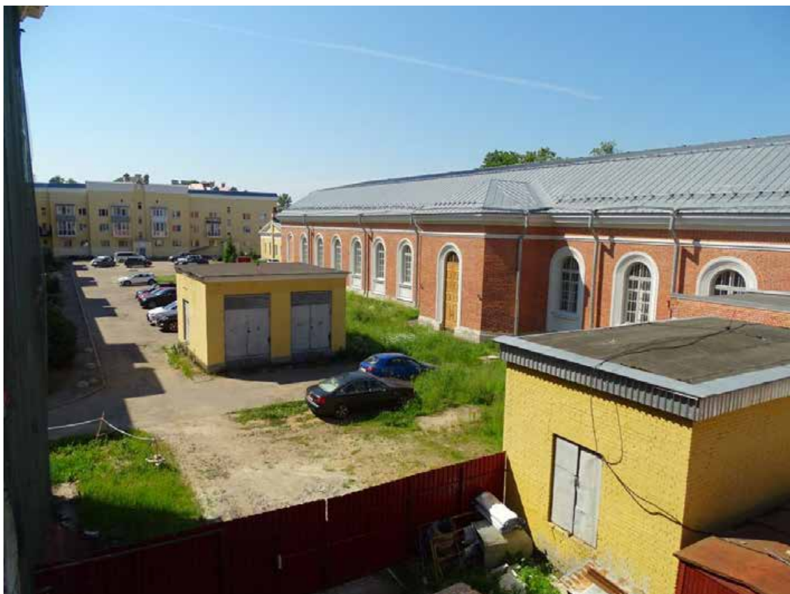
Фото 13. Объект культурного наследия регионального значения «Манеж Уланского полка». Западный фасад. Фрагмент кровли. Съемка 20.06.2022 г. Трушковский В. Э.
