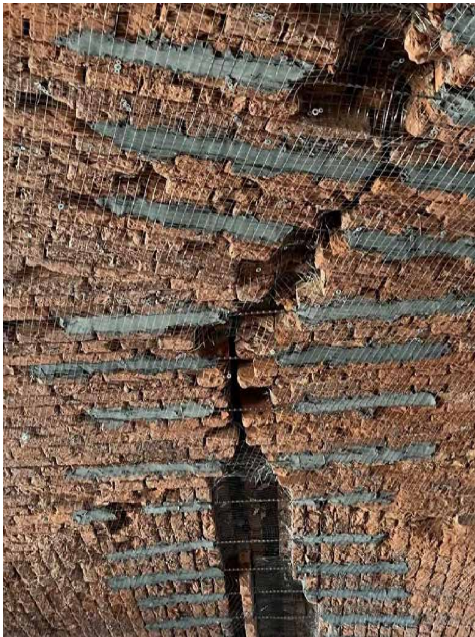
Фото 16. Первый этаж. Помещения казематов. Работы по усилению конструкций, находящихся в неудовлетворительном состоянии.
