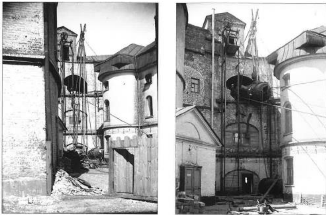
Илл. 104. Форт «Александр I». Подъем автоклава для пастеризации вакцин и сывороток на третий ярус форта. Начало XX в. // Л.И. Амирханов, Ю.П. Голиков, В.В. Чирков, Ю.Е. Иванова. Форт «Император Александр I» – СПб,: «Издательский центр «ОСТРОВ», 2008.
