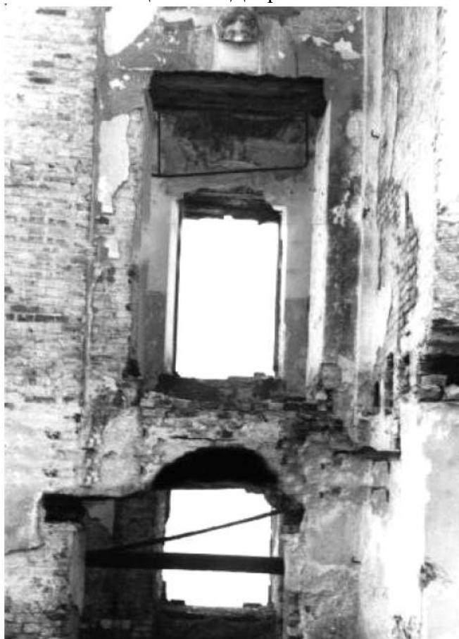
108. Вид разрушенного здания, где ранее находился Ленинградский институт инженеров молочной промышленности 1949г ЦГАКФФД Ар 202616
