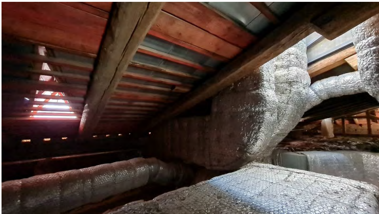
194. Объект культурного наследия федерального значения «Оранжерея Большая» по адресу: Санкт-Петербург, город Пушкин, Садовая ул., дом 14, литера А Помещение чердака корпуса по Оранжерейной улице Дата съемки: 29 апреля 2022 года
