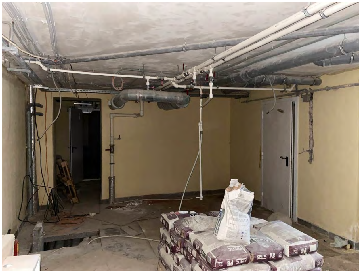
73. Объект культурного наследия федерального значения «Оранжерея Большая» по адресу: Санкт-Петербург, город Пушкин, Садовая ул., дом 14, литера А Помещение цокольного этажа Дата съемки: 29 апреля 2022 года
