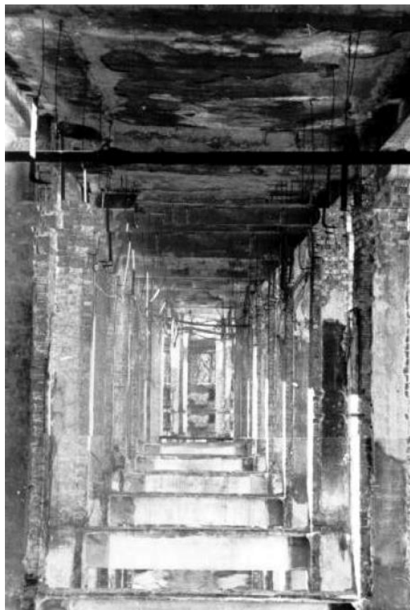
105. Вид разрушенного здания, где ранее находился Ленинградский институт инженеров молочной промышленности 1949г. ЦГАКФФД Ар 202623
