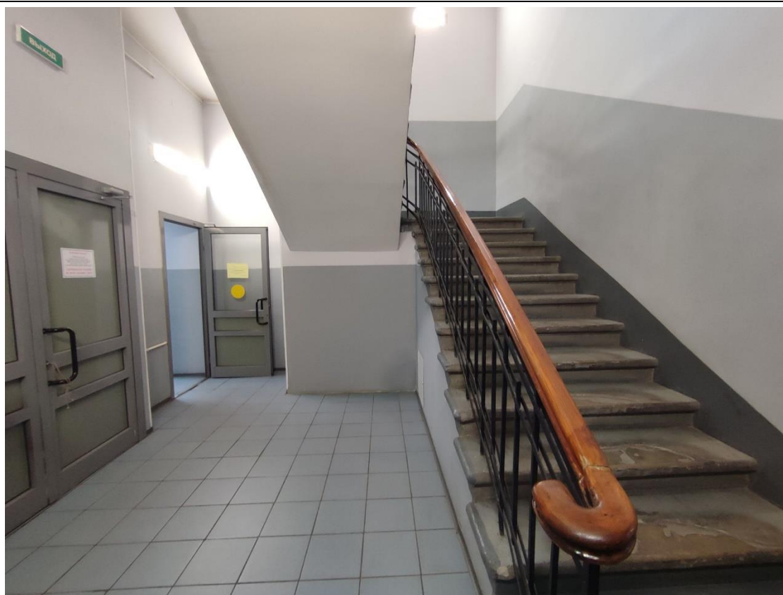
19. Общий вид двухмаршевой лестницы, расположенной в северо-восточной части здания (пом. 1-Н (21)) в уровне 1-го этажа.
