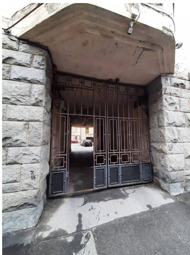
Фото 4. Фрагмент лицевого фасада выявленного объекта культурного наследия «Дом С.А.Визлер (А.Ф.Бубыря)», воротные проезд на Ковенский пер.
