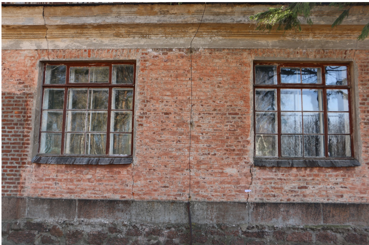
Фото 6. Трещины на северо-западном фасаде
