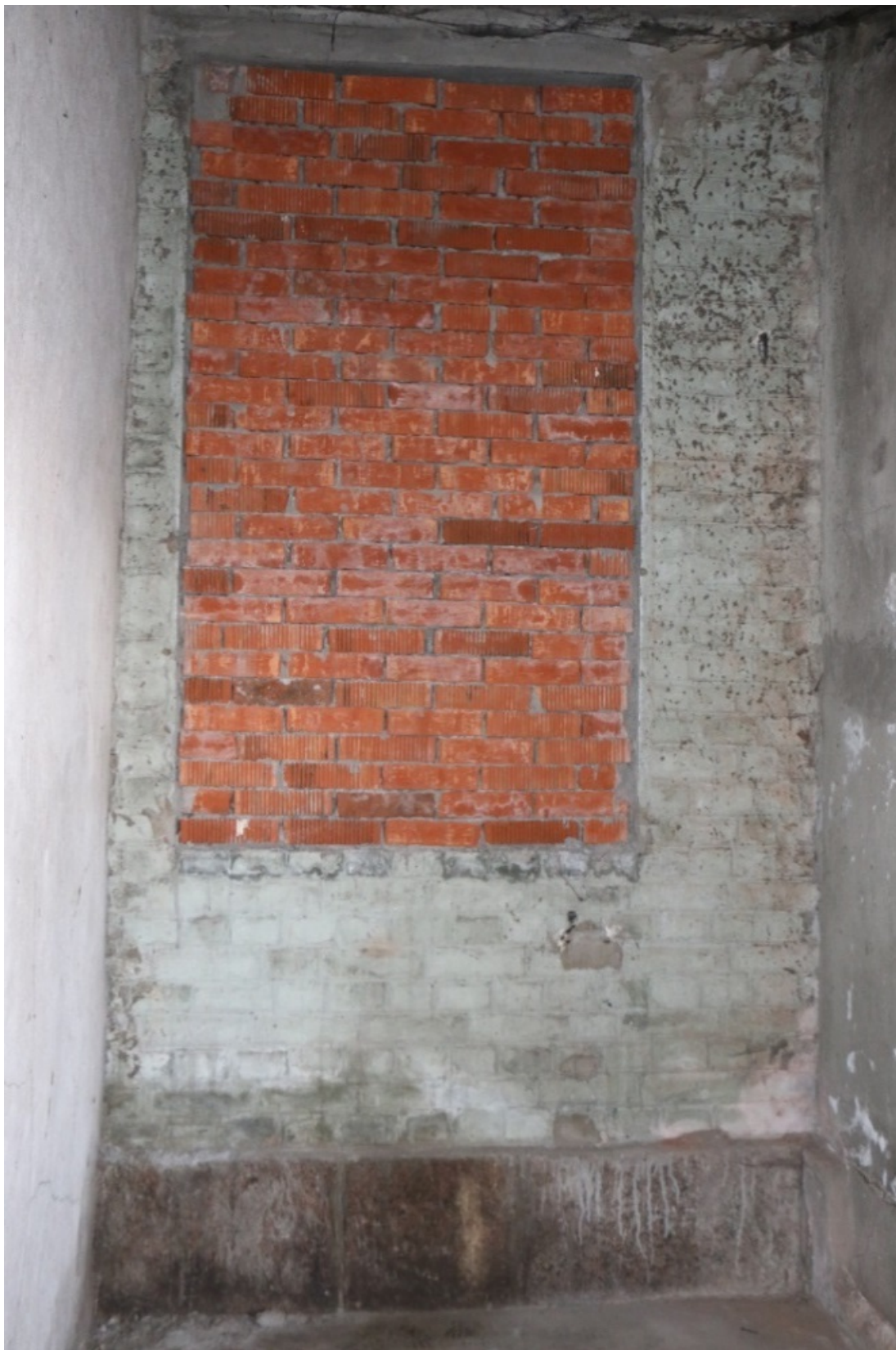
Фото 17. Караулка. Заложенный оконный проем на западном фасаде. Вид из пристройки.
