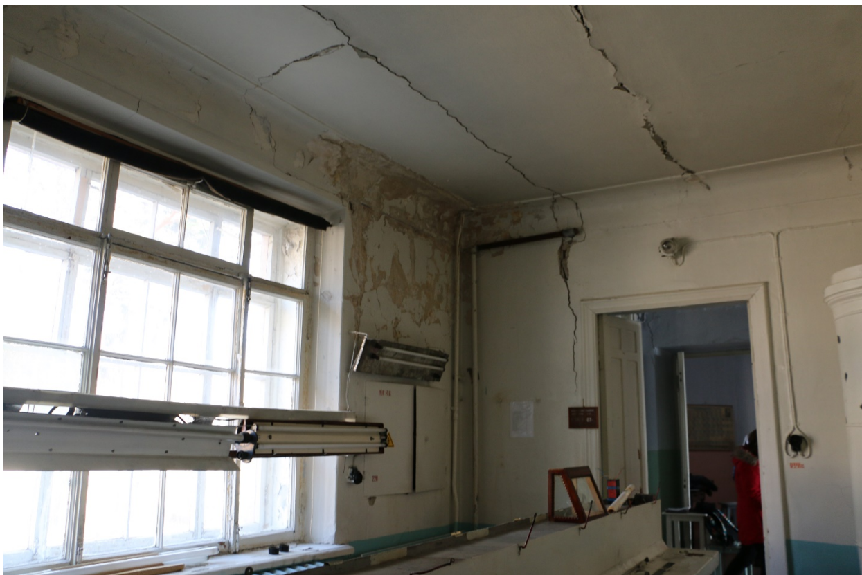
Фото 28. Состояние стен внутренних помещений.
