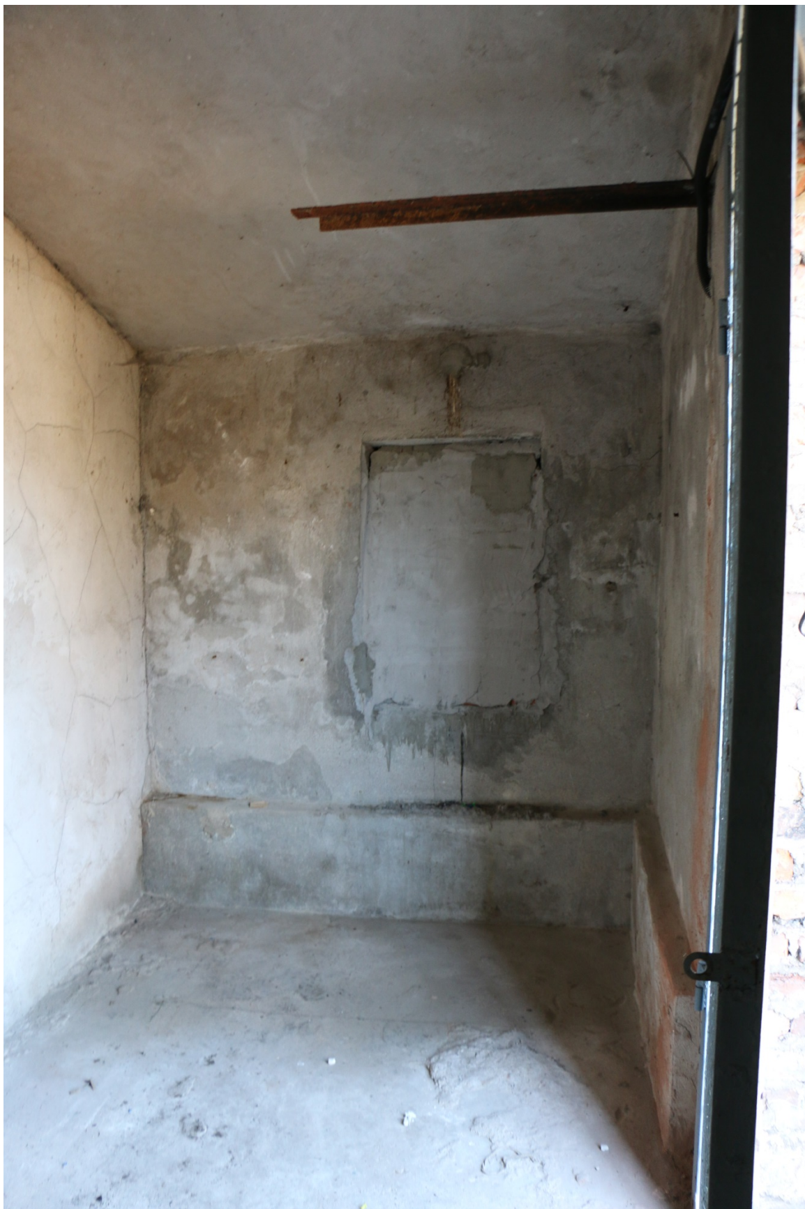
Фото 18. Караулка. Заложенный оконный проем пристройки.
