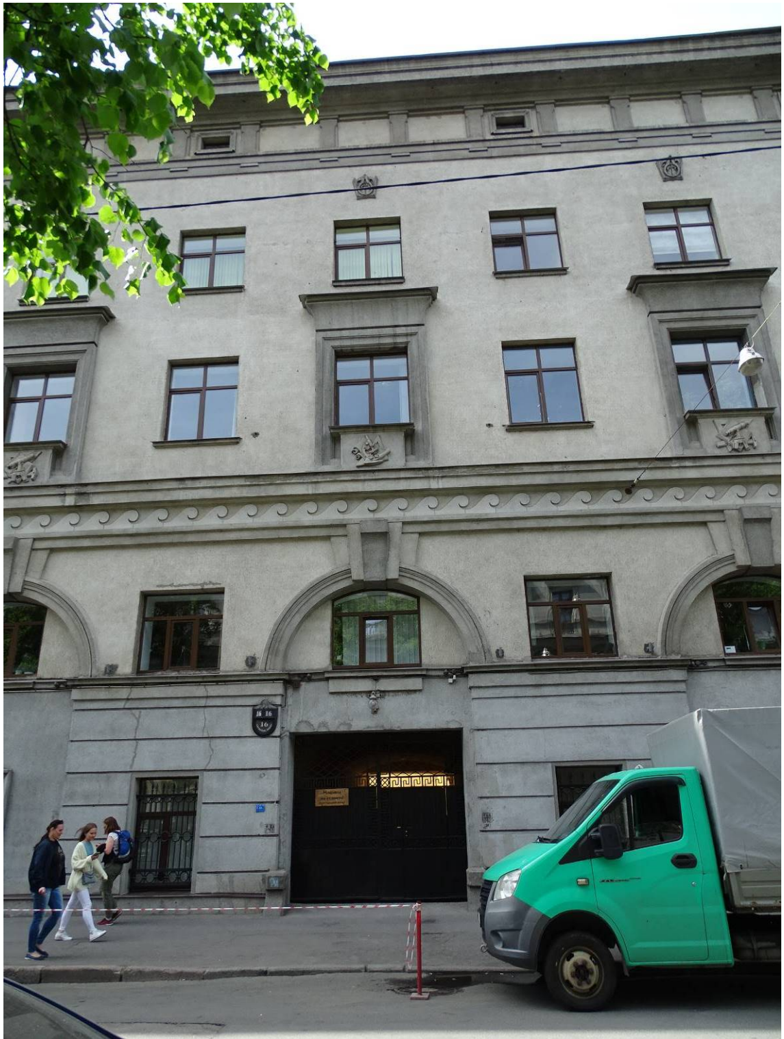
Фото 3. Выявленный объект культурного наследия «Склады торгового дома "Братья Елисеевы" (здание ГОИ им. С. И. Вавилова)». Восточный лицевой фасад. Фрагмент. Съемка 10.06.2022 г. Трушковский В.Э.
