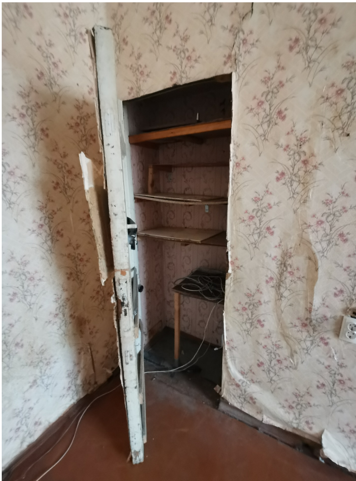
25. Вид на шкаф (помещение №7);
