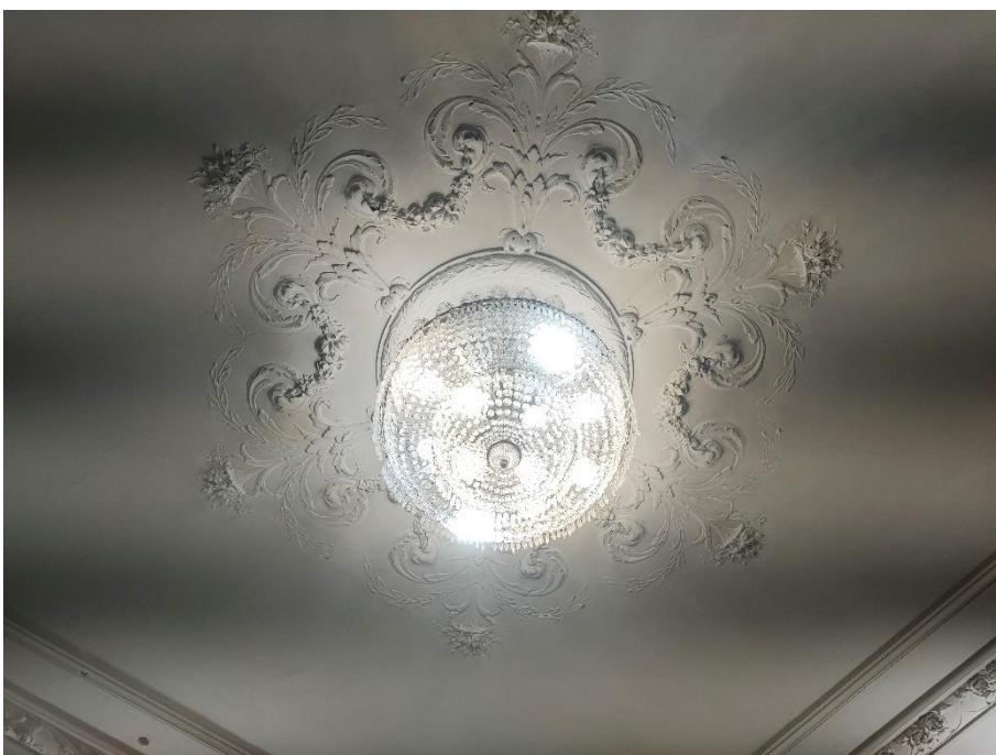
34. «Главный дом, ХУШв., 1-я пол. XIX в., 1886 г., арх. Гедике Р.А., 1907 г., арх. Мельцер Р.Ф.», входящий в состав объекта культурного наследия регионального значения: «Дом Уteman Ф.Ф., ХУШ-ХІХ в.в.», наб. Лейтенанта Шмидта д. 31, лит. А. Третий этаж. Помещение №57. Фрагмент. Фото 17.08.2022 г.
