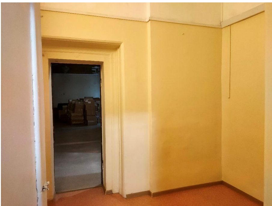
13. «Главный дом, ХУШв., 1-я пол. XIX в., 1886 г., арх. Гедике Р.А., 1907 г., арх. Мельцер Р.Ф.», входящий в состав объекта культурного наследия регионального значения: «Дом Уteman Ф.Ф., ХУШ-ХІХ в.в.», наб. Лейтенанта Шмидта д. 31, лит. А. Третий этаж. Помещение №61. Фрагмент. Фото 17.08.2022 г.
