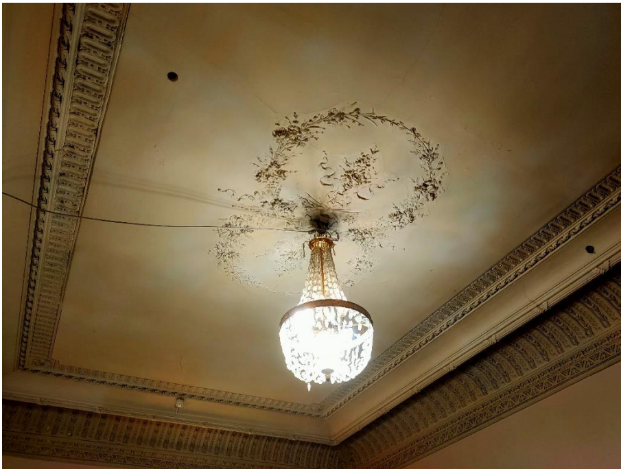
27. «Главный дом, ХУШв., 1-я пол. XIX в., 1886 г., арх. Гедике Р.А., 1907 г., арх. Мельцер Р.Ф.», входящий в состав объекта культурного наследия регионального значения: «Дом Утеман Ф.Ф., ХУШ-ХІХ в.в.», наб. Лейтенанта Шмидта д. 31, лит. А. Третий этаж. Помещение №58. Фрагмент. Фото 17.08.2022 г.
