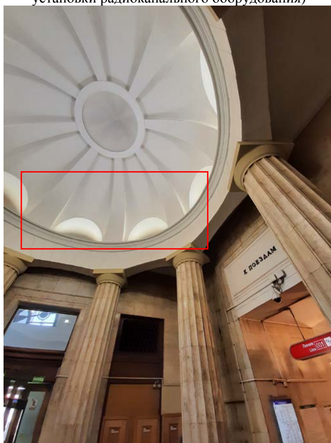
Фото 26 Фрагмент интерьера объекта культурного наследия регионального значения «Станция метро «Кировский завод», г. Санкт-Петербург, пр. Стачек, д. 70, литера А. (кассовый зал, места установки радиоканального оборудования)
