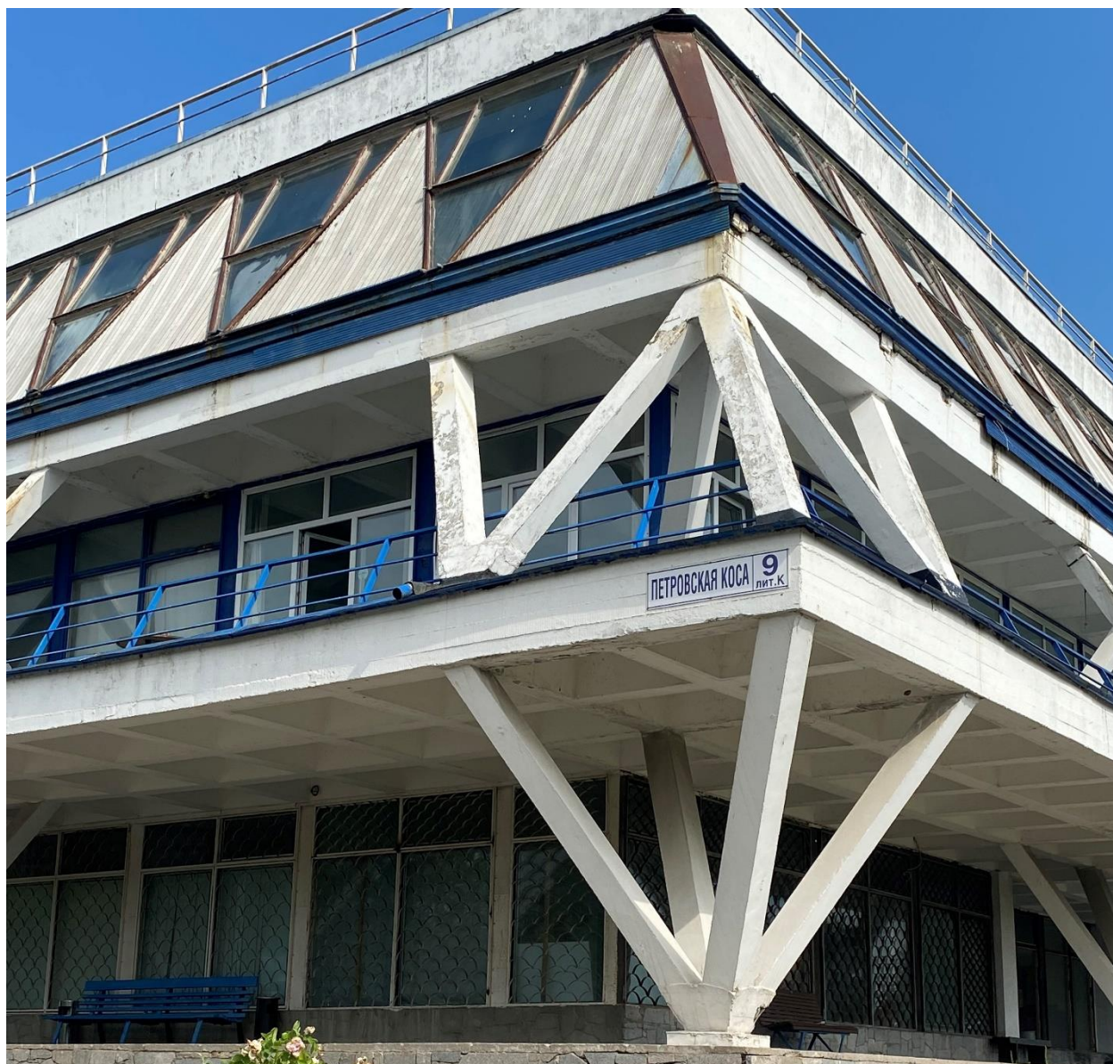
Фото 1. Южный фасад. Фрагмент. Сборные железобетонные пирамидальные элементы 1-го и 2-го этажей. Наружные ограждающие конструкции в виде легких навесных и металлических витражей с двойным остеклением. Металлические рамы панелей и треугольных витражей подвержены коррозии.
