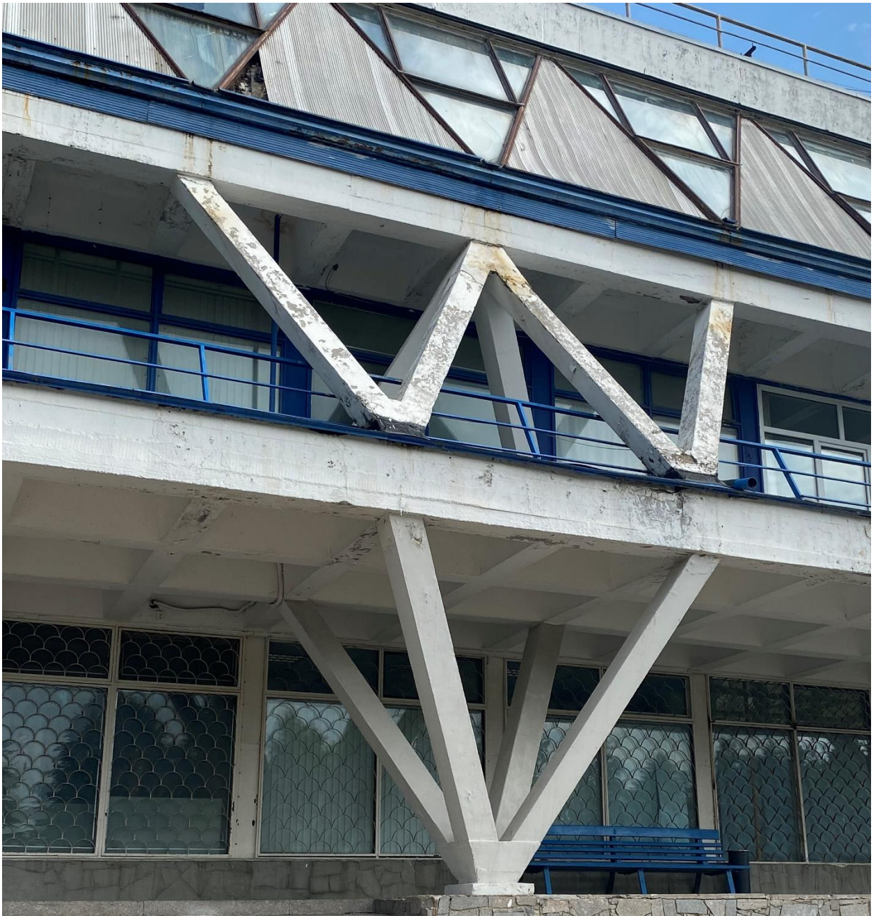
Фото 3. Южный фасад. Фрагмент. Сборные железобетонные пирамидальные элементы 1-го и 2-го этажей. Деструкция бетона стержней пирамидальных элементов и плиты кессонированного перекрытия, значительные загрязнения и утраты красочного слоя конструкций. Наружные ограждающие конструкции в виде легких навесных и металлических витражей с двойным остеклением. Металлические рамы панелей и треугольных витражей подвержены коррозии, утраты и повреждения обшивки панелей.
