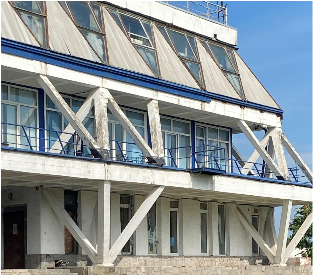
Фото 2. Восточный фасад. Фрагмент. Сборные железобетонные пирамидальные элементы 1-го и 2-го этажей. Деструкция бетона стержней пирамидальных элементов и плиты кессонированного перекрытия, значительные загрязнения и утраты красочного слоя конструкций. Наружные ограждающие конструкции в виде легких навесных и металлических витражей. Ограждающая кирпичная стена части фасада.
