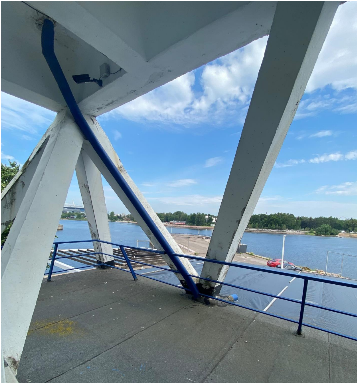
Фото 5. Фрагмент периметрального балкона 2-го этажа. Пространственный каркас из сборных железобетонных пирамидальных элементов. Деструкция бетона стержней пирамидальных элементов и плиты кессонированного перекрытия, значительные загрязнения и утраты красочного слоя конструкций.
