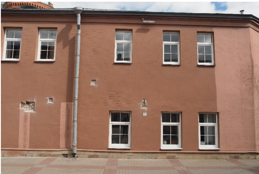
22. «Машинное отделение №3 с мастерскими и котельной и кладовые» в составе ансамбля «Комплекс главной станции Санкт-Петербургских городских водопроводов», ул. Шпалерная, д. 56, лит. АИ. Западный фасад. Фрагмент. Фото 08.08.2022г.
