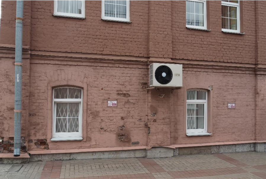
9. «Машинное отделение №3 с мастерскими и котельной и кладовые» в составе ансамбля «Комплекс главной станции Санкт-Петербургских городских водопроводов», ул. Шпалерная, д. 56, лит. АИ. Восточный фасад. Фрагмент. Фото 08.08.2022г.
