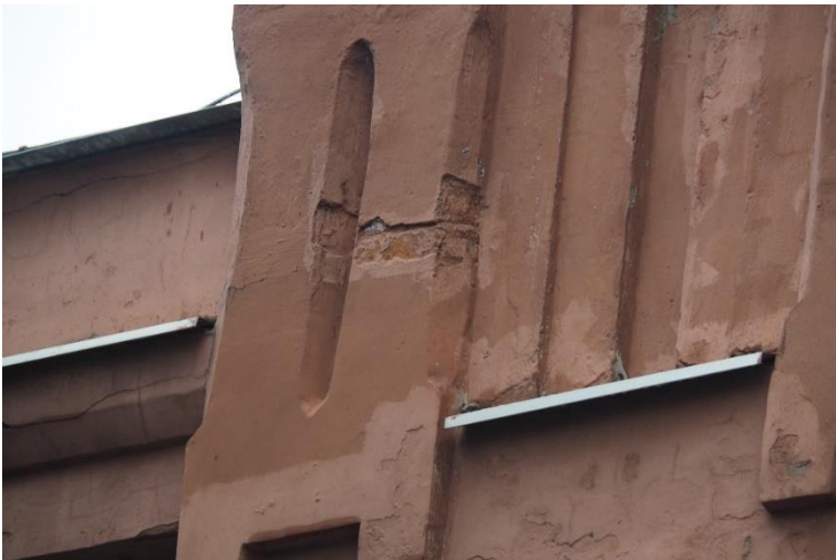
13. «Машинное отделение №6 с котельной» в составе ансамбля «Комплекс главной станции Санкт-Петербургских городских водопроводов», ул. Таврическая, д. 10, лит. А. Восточный фасад. Фрагмент. Фото 08.08.2022г.
