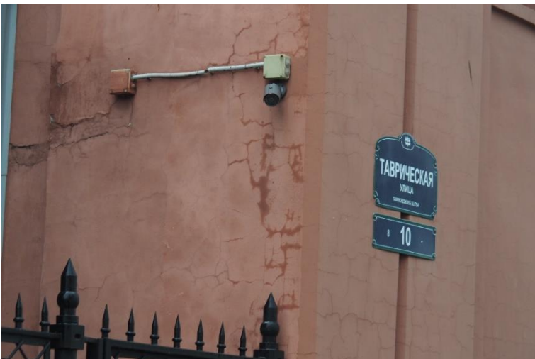
14. «Машинное отделение №6 с котельной» в составе ансамбля «Комплекс главной станции Санкт-Петербургских городских водопроводов», ул. Таврическая, д. 10, лит. А. Восточный фасад. Фрагмент. Фото 08.08.2022г.
