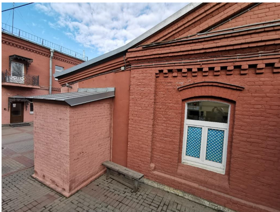
29. "Служебное здание" в составе ансамбля "Комплекс главной станции Санкт-Петербургских городских водопроводов", ул. Шпалерная, д. 56, лит. Р. Западный фасад. Фрагмент. Фото 08.08.2022г.
