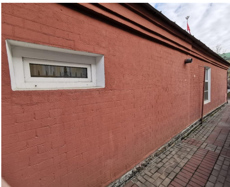
30. "Служебное здание" в составе ансамбля "Комплекс главной станции Санкт-Петербургских городских водопроводов", ул. Шпалерная, д. 56, лит. Р. Западный фасад. Фрагмент. Фото 08.08.2022г.
