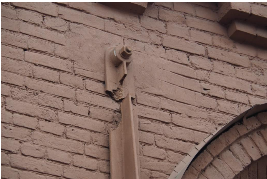
30. «Машинное отделение №3 с мастерскими и котельной и кладовые» в составе ансамбля «Комплекс главной станции Санкт-Петербургских городских водопроводов», ул. Шпалерная, д. 56, лит. АК. Западный фасад. Фрагмент. Фото 08.08.2022г.
