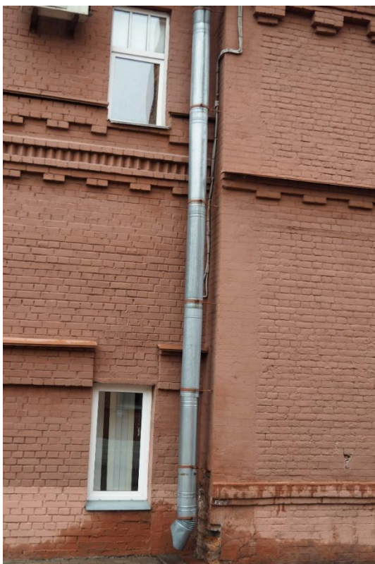
15. «Машинное отделение №3 с мастерскими и котельной и кладовые» в составе ансамбля «Комплекс главной станции Санкт-Петербургских городских водопроводов», ул. Шпалерная, д. 56, лит. АК. Восточный фасад. Фрагмент. Фото 08.08.2022г.
