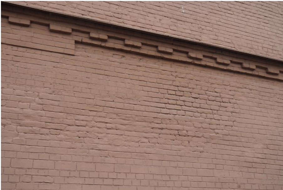
22. «Машинное отделение №3 с мастерскими и котельной и кладовые» в составе ансамбля «Комплекс главной станции Санкт-Петербургских городских водопроводов», ул. Шпалерная, д. 56, лит. АК. Северный фасад. Фрагмент. Фото 08.08.2022г.
