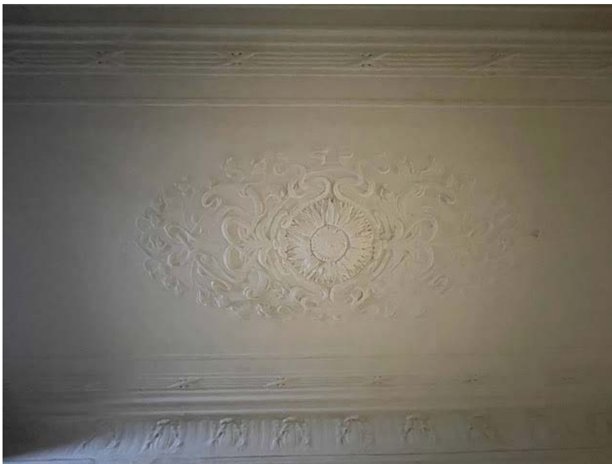
153. Потолок вестибюля лестничной клетки №1
