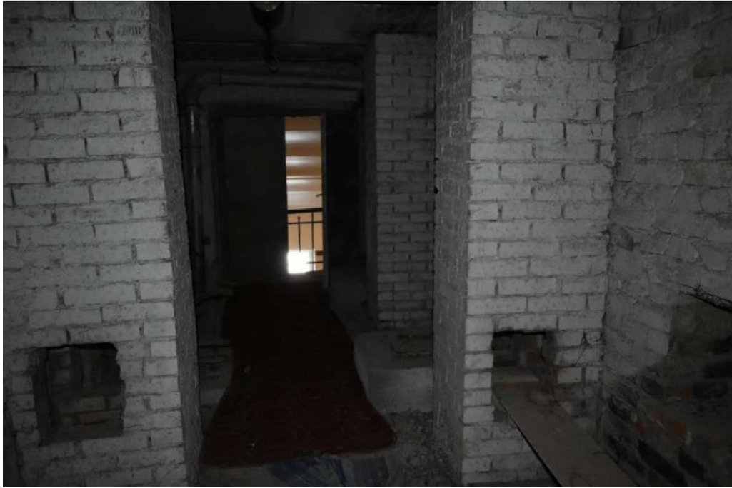
27. Объект культурного наследия федерального значения «Больница», входящий в состав объекта культурного наследия федерального значения «Монастырь Воскресенский Новодевичий» по адресу: г. Санкт-Петербург, Московский проспект, д. 100, лит. П. Чердак. Общий вид. Дымовые трубы.
