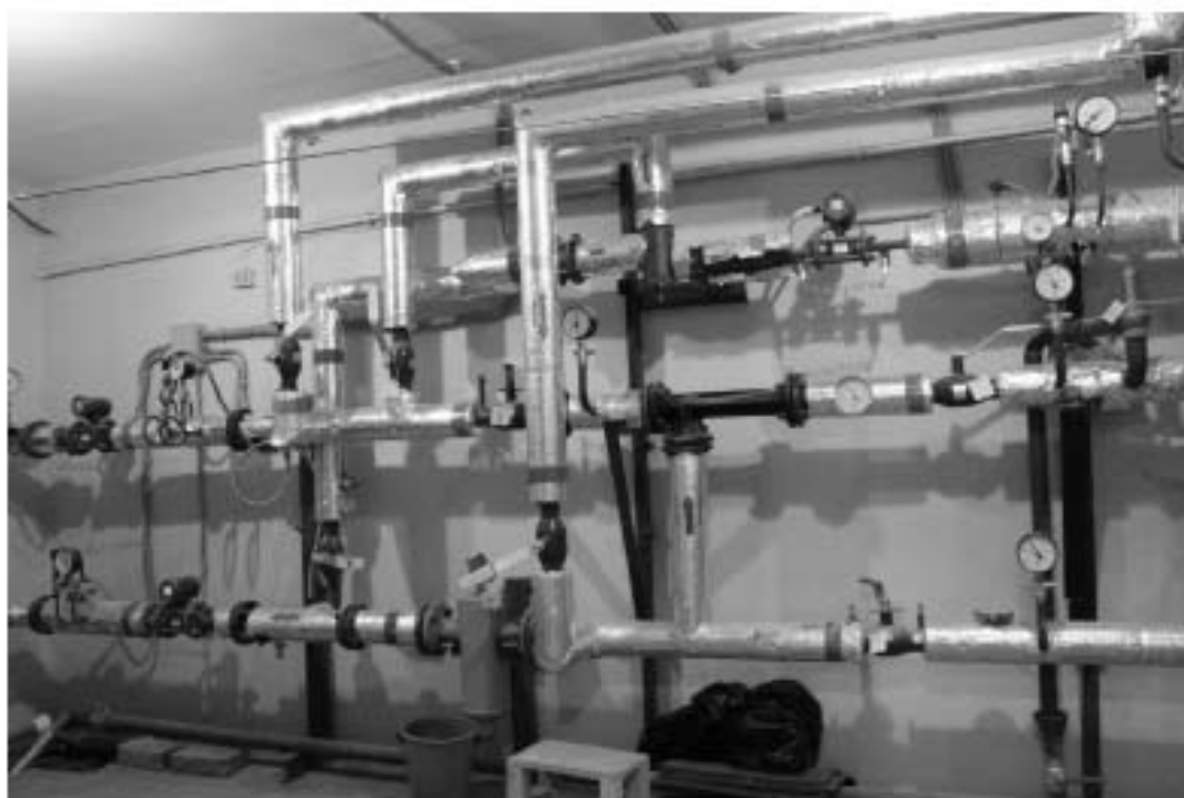
Фото 29. Флигель №3. 1 этаж. Водомерный узел.
