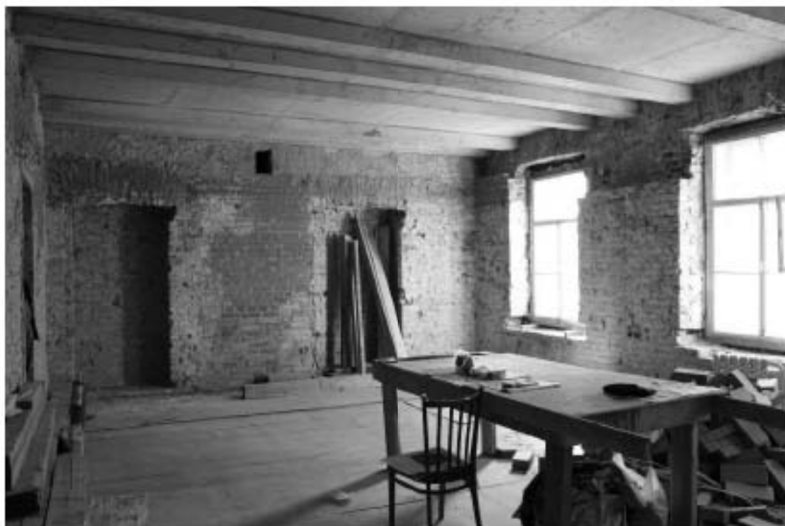
Фото 34. Флигель №3. 2 этаж. Заложенные проемы в стене.
