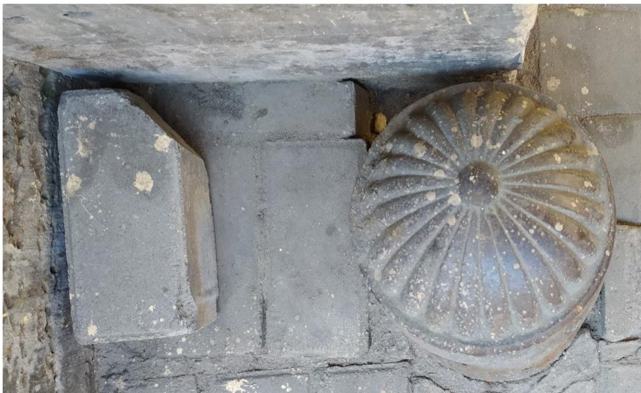
Фото 11. Колесоотбойная тумба с левой стороны воротного проезда лицевого фасада 4-х этажного лицевого корпуса по ул. Некрасова.
