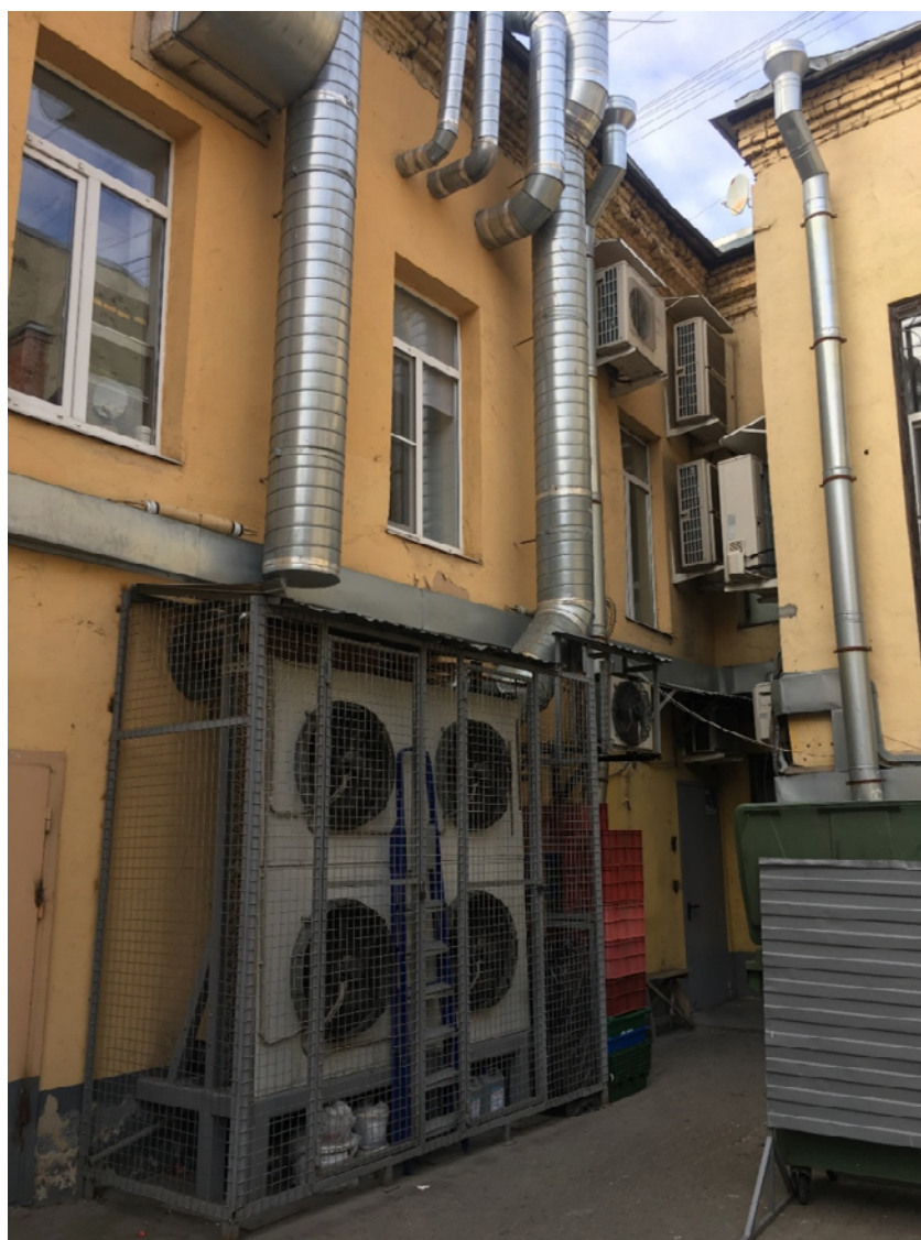
Фото №15. Юго-восточный дворовый фасад, инженерное оборудование.
