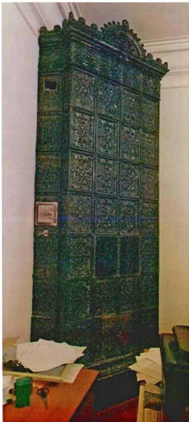
13. Печь, расположенная в помещении 1 этажа
