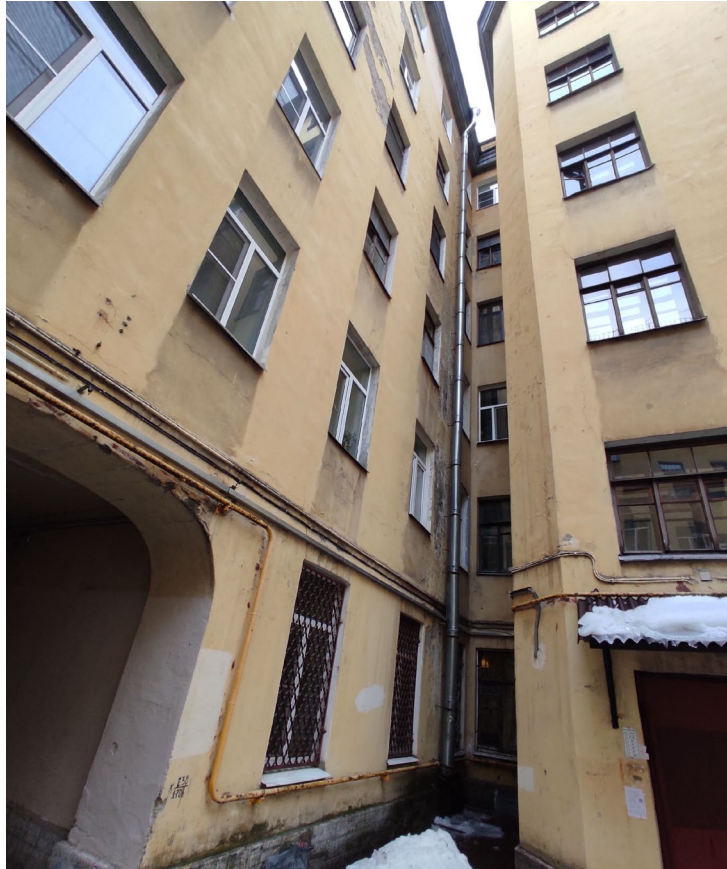
Фото 19. Фасад 10-2. Шелушение красочного слоя пилона. Деструкция штукатурного слоя, высолы, биопоражения, ржавчина
