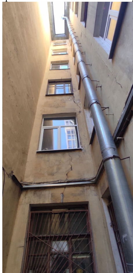
Фото 18. Трещины на фасаде К-Е
