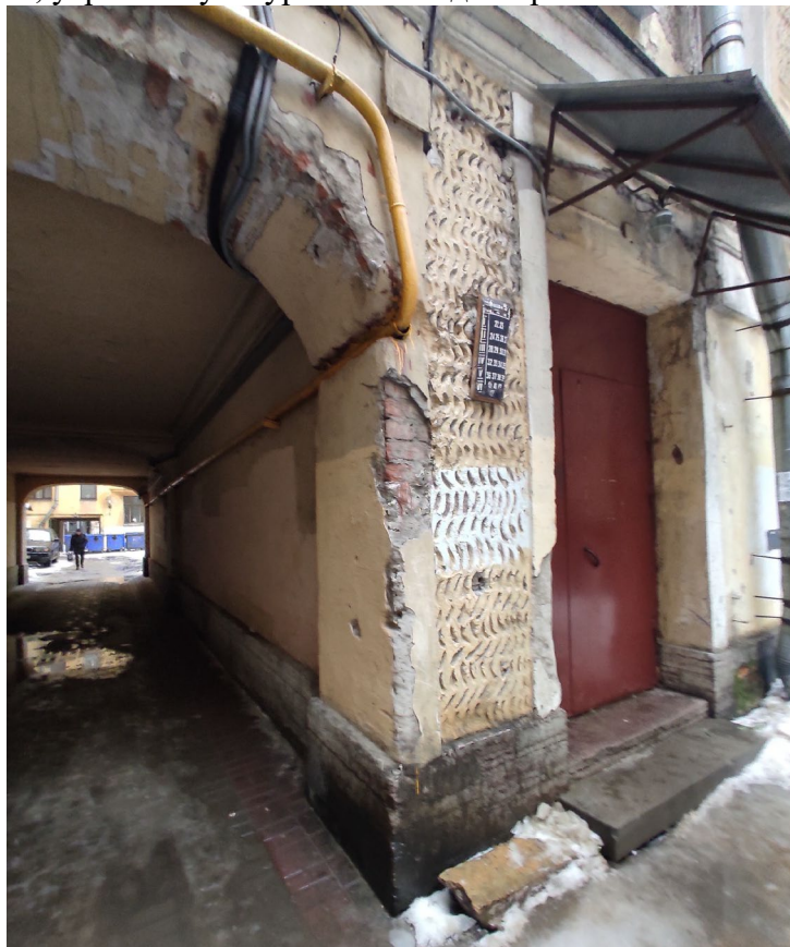
Фото 12. Фасад 2-9. Проездная арка. Утраты штукатурного слоя до кирпичного
