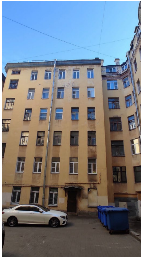
Фото 17. Шелушение красочного слоя пилона. Деструкция штукатурного слоя, высолы, биопоражения, ржавчина. Утрата дверного заполнения, коррозия исторического металлического козырька
