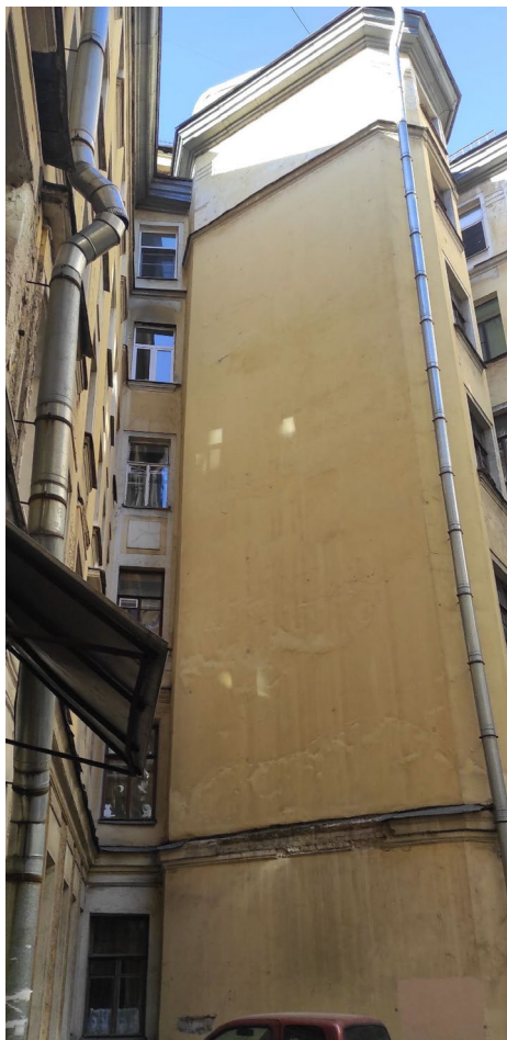
Фото 11. Фасад Г'-Б'. Биопоражения, замокания, высолы, утрата штукатурной тяги, утрата штукатурного слоя до кирпичного основания
