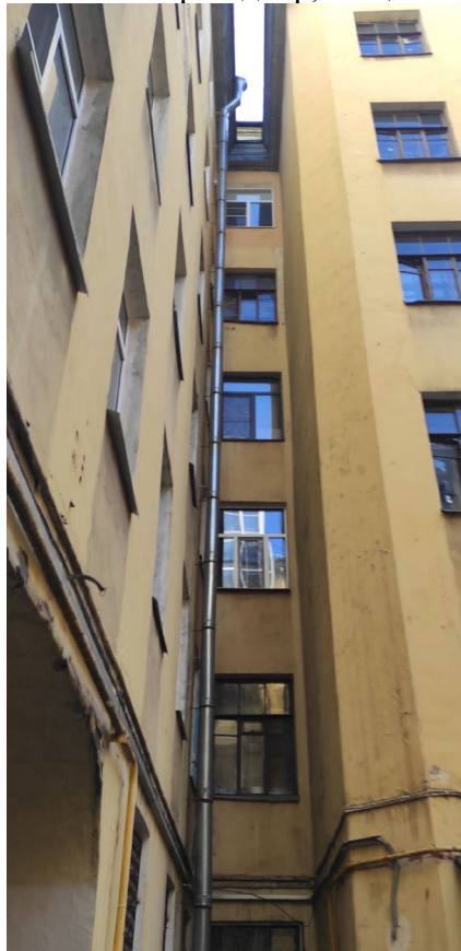
Фото 16. Фасад Е-К. Загрязнения фасада, высолы, утраты и разрушения штукатурного слоя
