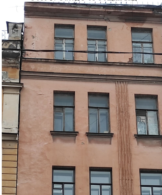
Фото 4. Лицевой фасад по пр. Бакунина. Деструкция красочного и штукатурного слоев. Множественные замокания, утрата лепного декора в виде женской головы, утрата лепного декора с цветочным орнаментом между 5 и 6 этажами
