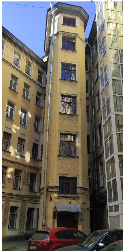
Фото 10. Фасад Г'-Б'. Биопоражения, замокания, высолы, утрата штукатурной тяги, трещины в штукатурном слое, разрушение линейных окрытий и козырька
