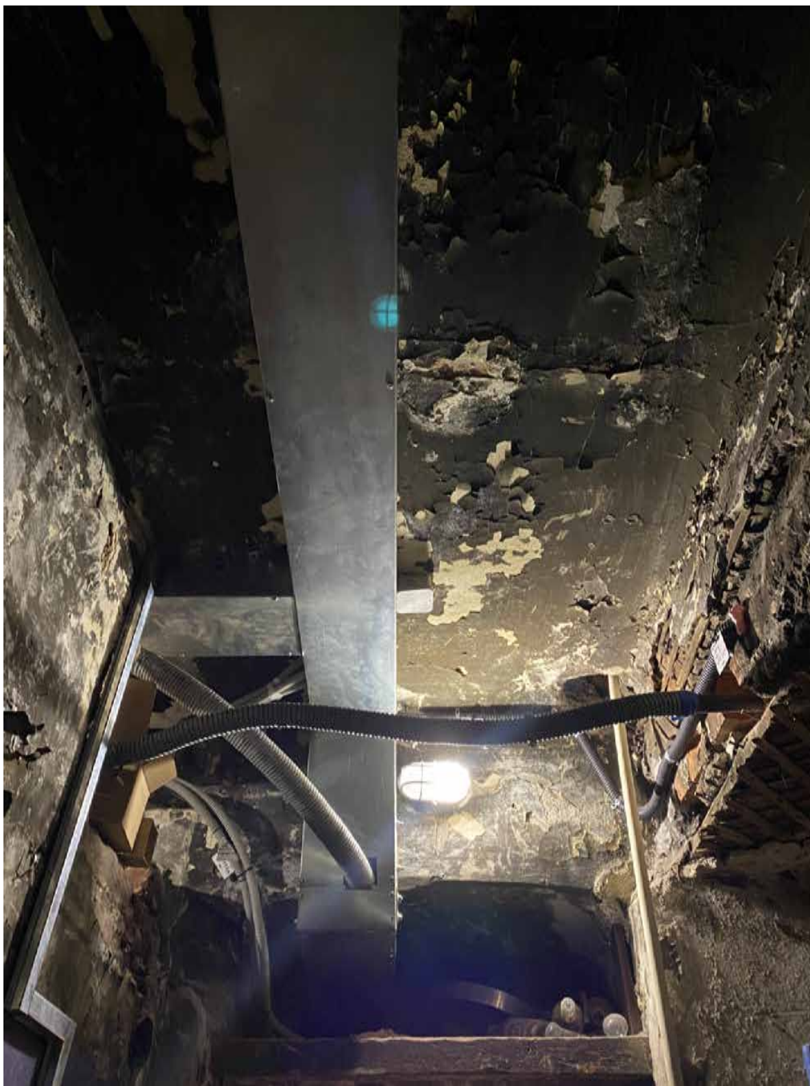
Фото 32. Вид на помещение с ГРЩ объекта культурного наследия.
