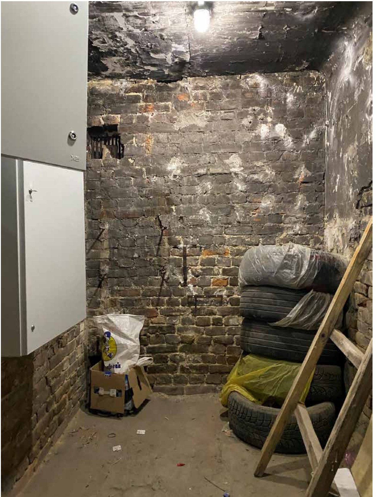
Фото 31. Вид на помещение с ГРЩ объекта культурного наследия.
