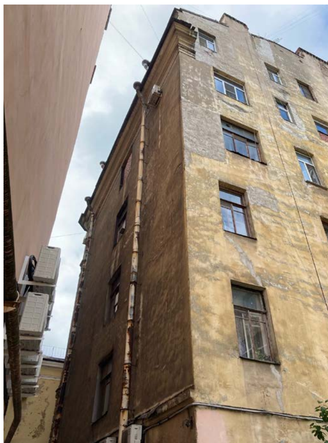
Фото 16. Фрагмент дворового фасада объекта культурного наследия регионального значения «Дом Единоверческой церкви Св. Николая».
