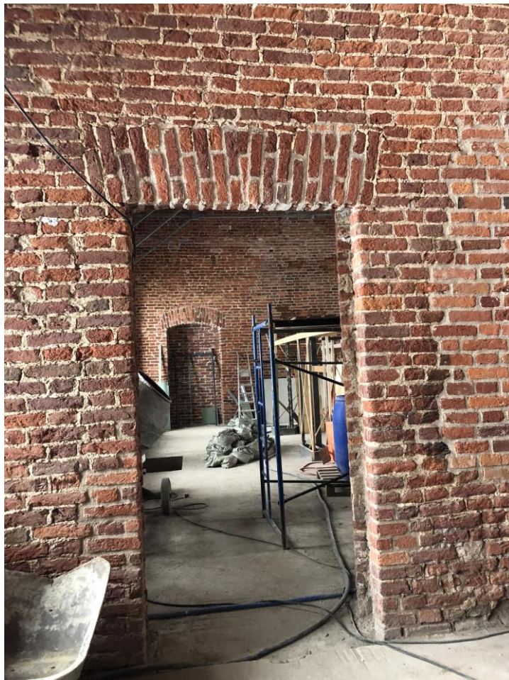
27. Объект культурного наследия регионального значения «б. Голландская кухня», расположенного по адресу: г. Санкт-Петербург, Кронштадтский район, г. Кронштадт, ул. Макаровская, д. 2а, литера А. Восточная часть здания. Вид в сторону центральной части. Фрагмент интерьера.
