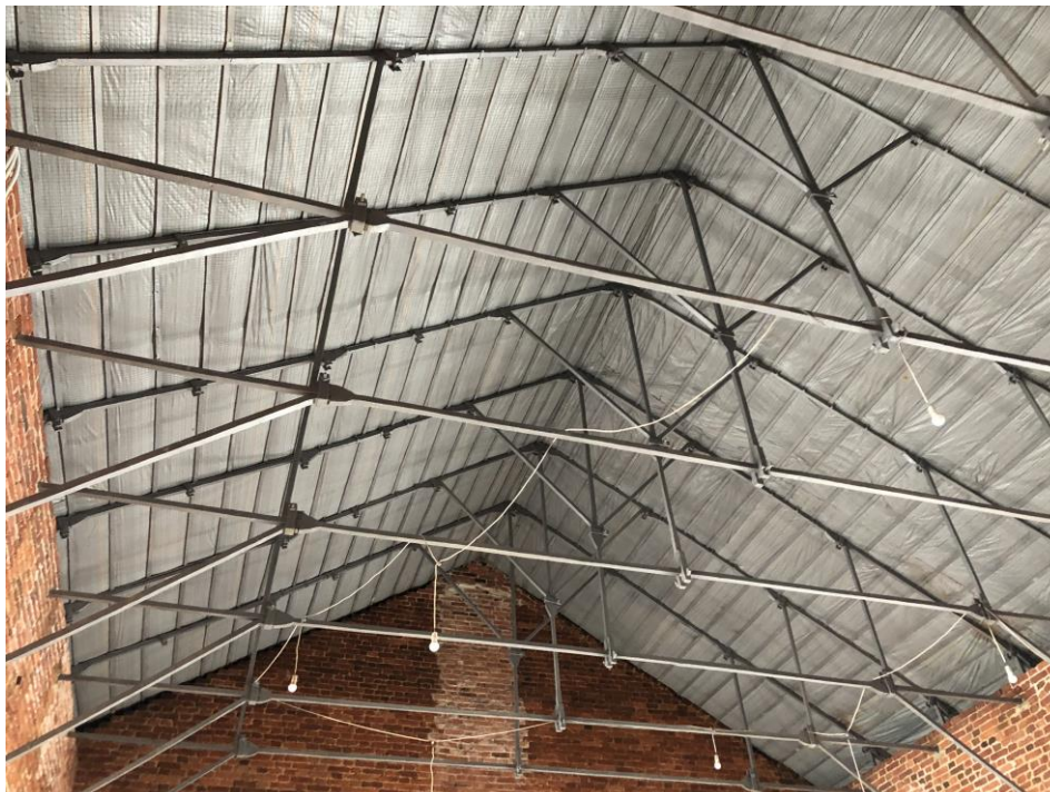
25. Объект культурного наследия регионального значения «б. Голландская кухня», расположенного по адресу: г. Санкт-Петербург, Кронштадтский район, г. Кронштадт, ул. Макаровская, д. 2а, литера А. Центральная часть здания. Фрагмент стропильной системы.
