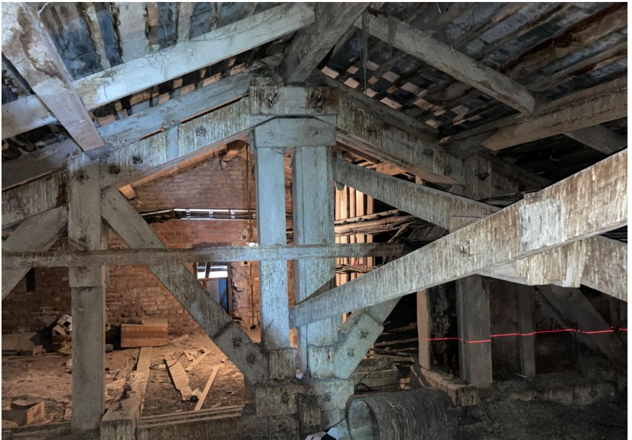
Фото 30. Выявленный ОКН «Здание Государственного Заемного банка (с оградой)». Общий вид стропильной системы крыши в осях «1-3//Е-Ж». Съёмка 26.04.2021 г.
