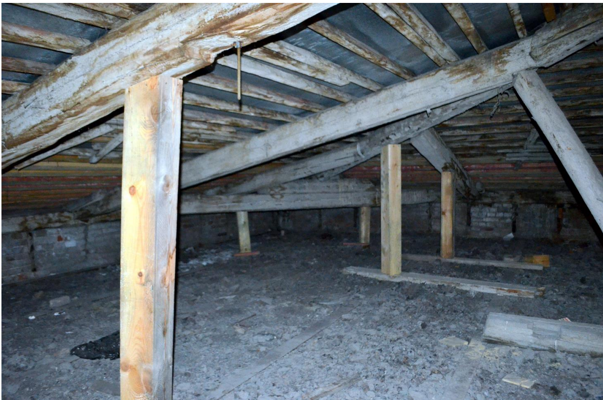
Фото 24. Выявленный ОКН «Здание Государственного Заемного банка (с оградой)». Общий вид стропильной системы крыши в осях «1-2//А-Б». Съёмка 26.04.2021 г.
