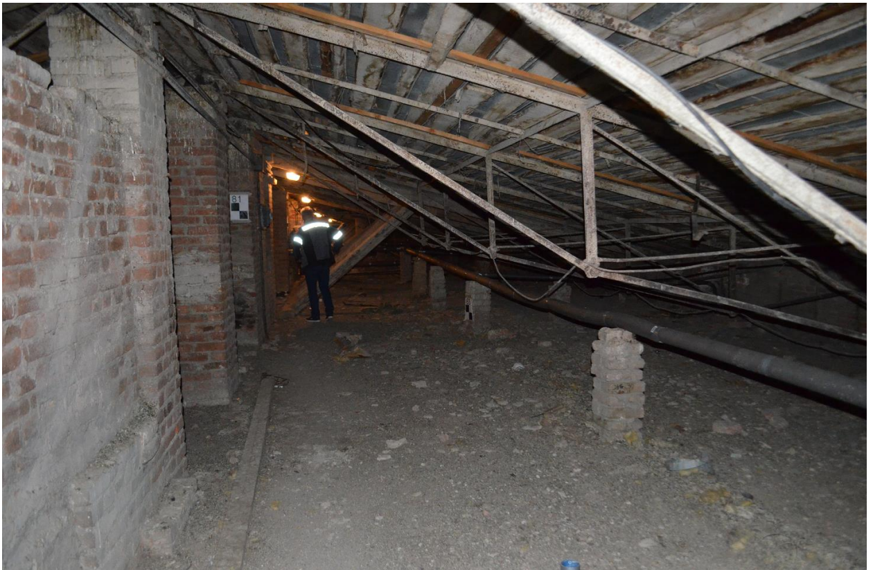
Фото 10. Выявленный ОКН «Здание Государственного Заемного банка (с оградой)». Общий вид чердачного помещения в осях «11-12//Д/12-Е/12». Съёмка 26.04.2021 г.
