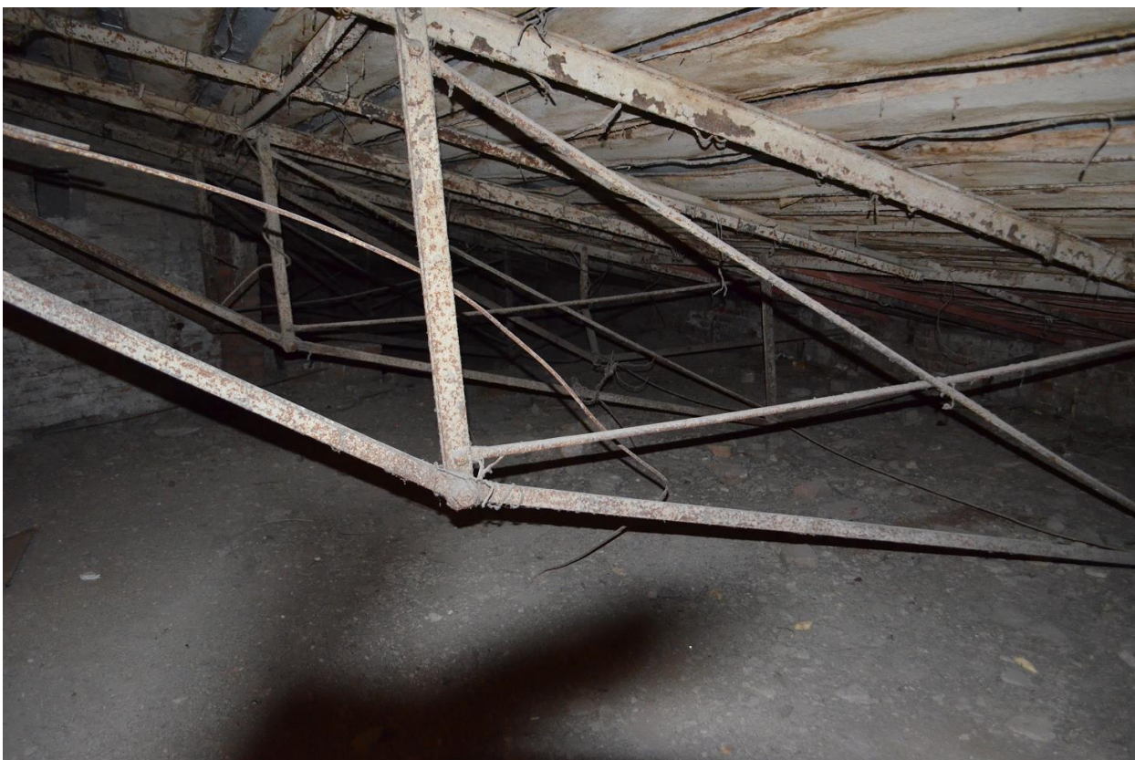
Фото 02. Выявленный ОКН «Здание Государственного Заемного банка (с оградой)». Общий вид стропильных конструкции крыши в осях «10-11//А-Б». Съёмка 26.04.2021 г.
