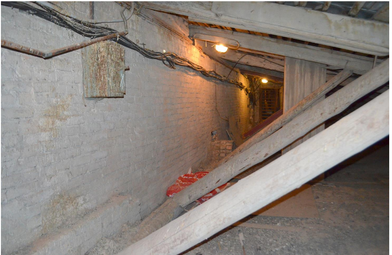
Фото 25. Выявленный ОКН «Здание Государственного Заемного банка (с оградой)». Общий вид стропильной системы крыши в осях «7-9//А-В». Съёмка 26.04.2021 г.
