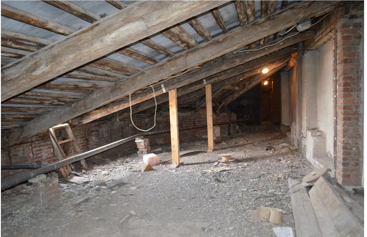
Фото 27. Выявленный ОКН «Здание Государственного Заемного банка (с оградой)». Общий вид стропильной системы крыши в осях «7-9//Г-Е». Съёмка 26.04.2021 г.
