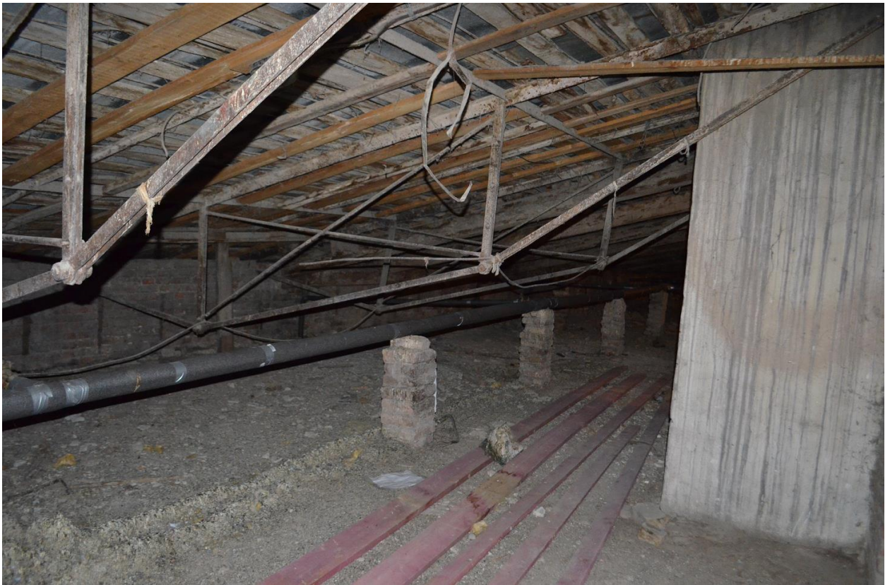
Фото 12. Выявленный ОКН «Здание Государственного Заемного банка (с оградой)». Общий вид чердачного помещения в осях «11-12//Д/12-Е/12». Съёмка 26.04.2021 г.
