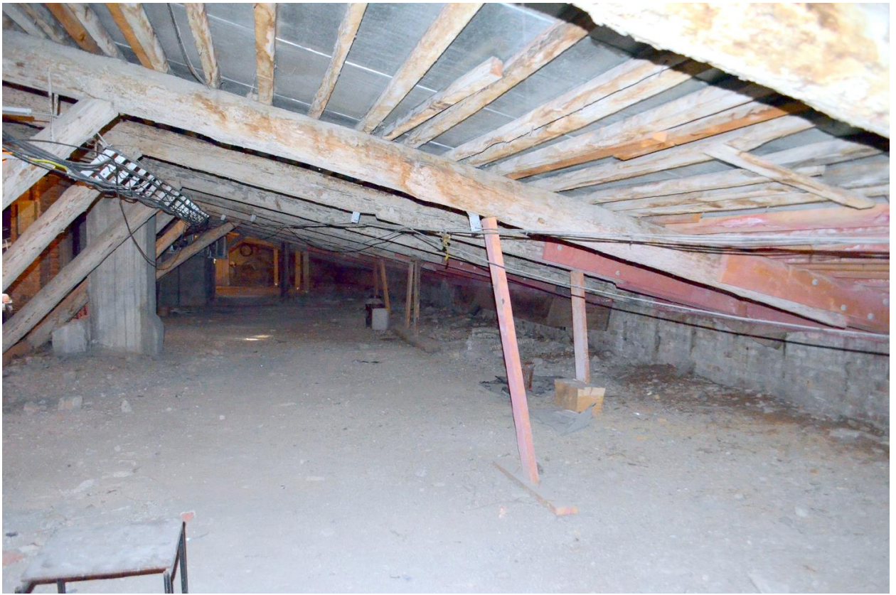
Фото 20. Выявленный ОКН «Здание Государственного Заемного банка (с оградой)». Общий вид стропильной системы крыши в осях «4-7//А-В». Съёмка 26.04.2021 г.
