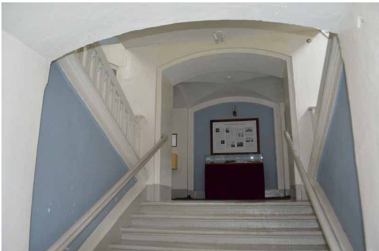
Фото 57. Объект культурного наследия федерального значения «Церковь лютеранская Воскресения Христова». Второй этаж. Помещение 1-Н (2). Лестница. Фрагмент. Съёмка 31.10.2022 г.
