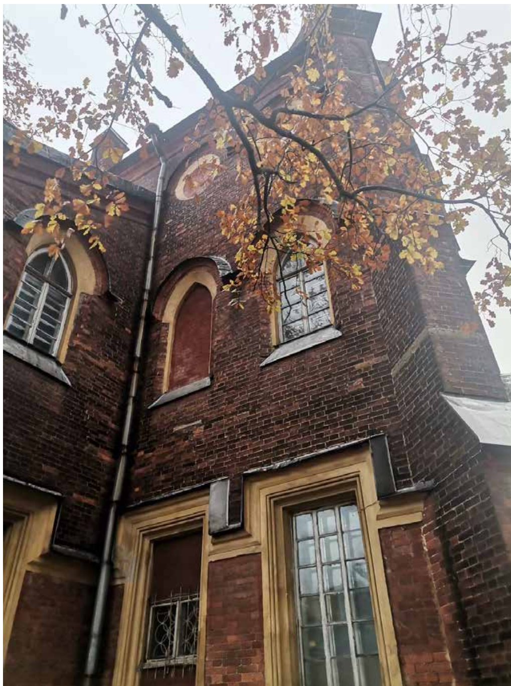
Фото 27. Объект культурного наследия федерального значения «Церковь лютеранская Воскресения Христова». Юго-западный фасад. Фрагмент. Съёмка 31.10.2022 г.
