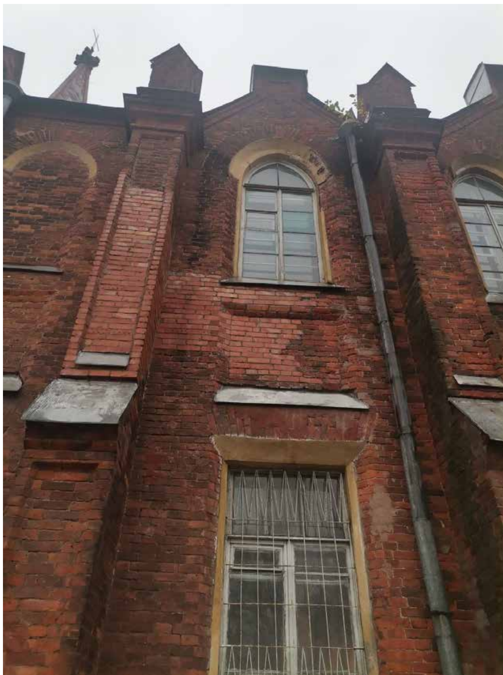
Фото 10. Объект культурного наследия федерального значения «Церковь лютеранская Воскресения Христова». Северо-восточный фасад. Фрагмент. Съёмка 31.10.2022 г.
