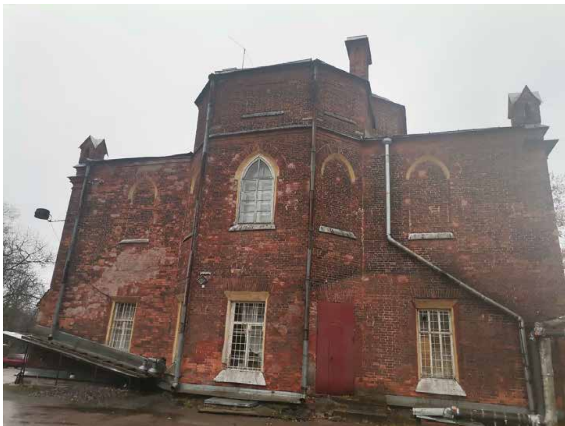
Фото 15. Объект культурного наследия федерального значения «Церковь лютеранская Воскресения Христова». Северо-западный фасад. Общий вид. Съёмка 31.10.2022 г.
