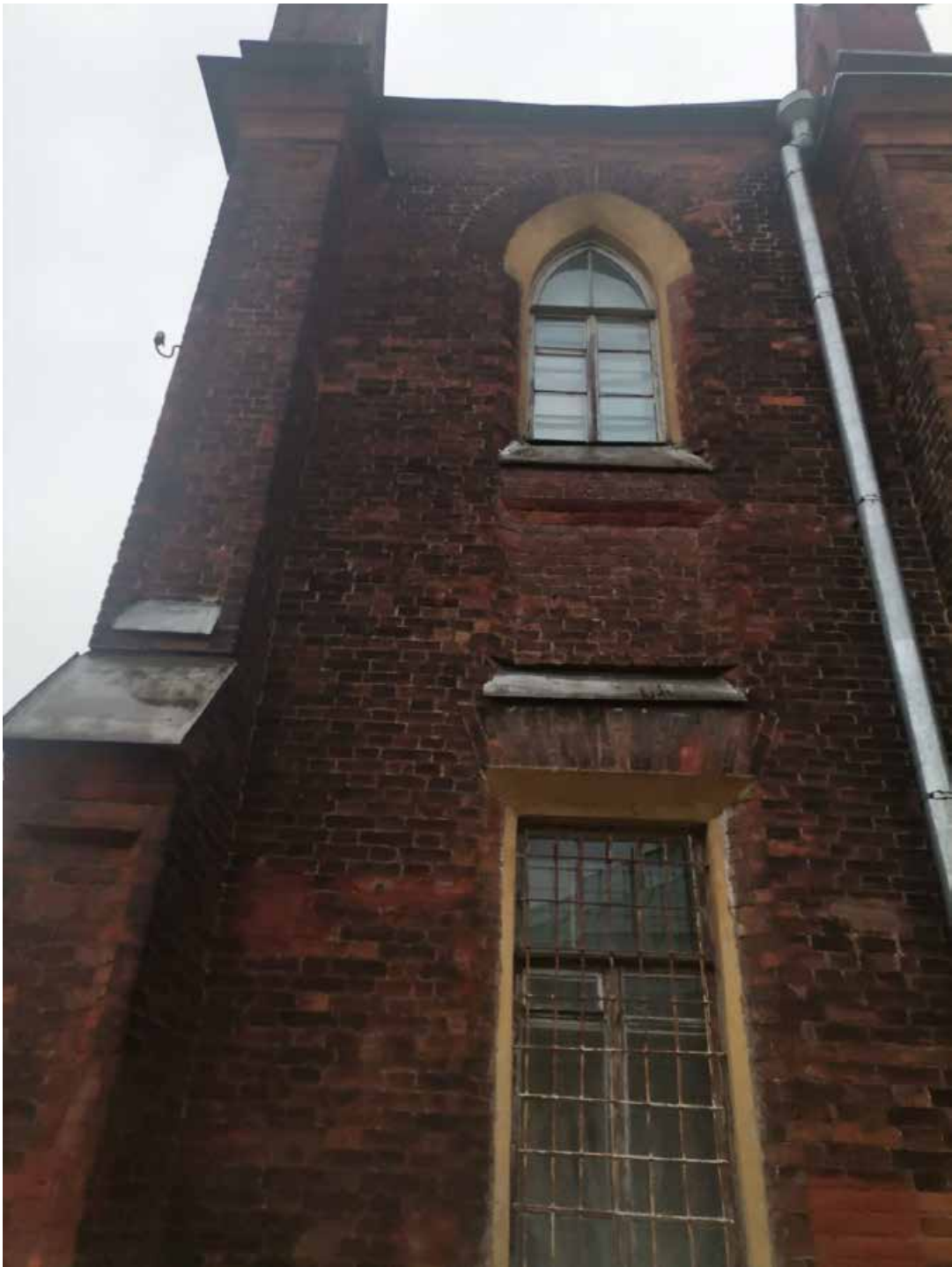
Фото 21. Объект культурного наследия федерального значения «Церковь лютеранская Воскресения Христова». Юго-западный фасад. Фрагмент. Съёмка 31.10.2022 г.
