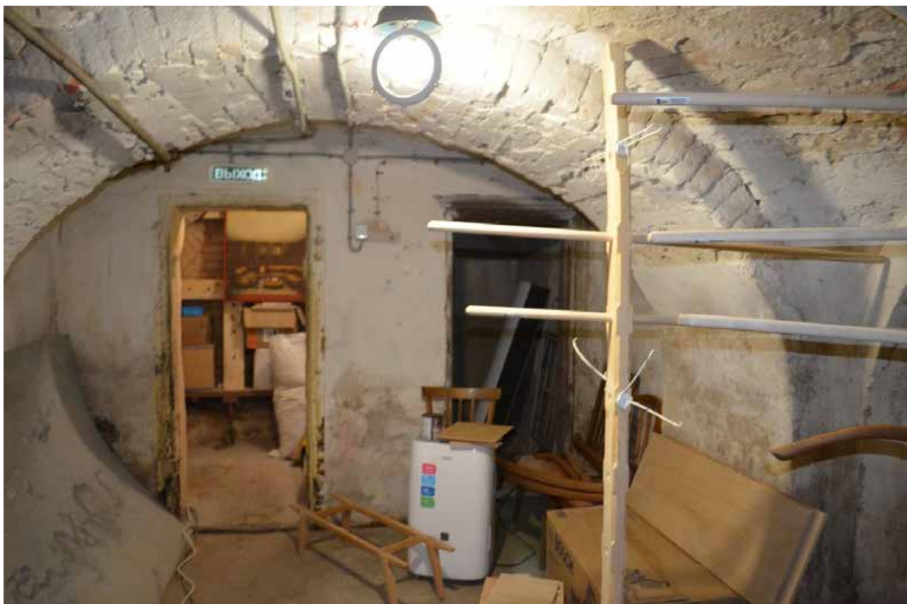
Фото 36. Объект культурного наследия федерального значения «Церковь лютеранская Воскресения Христова». Подвал. Помещение 2-Н (5). Фрагмент. Съёмка 31.10.2022 г.
