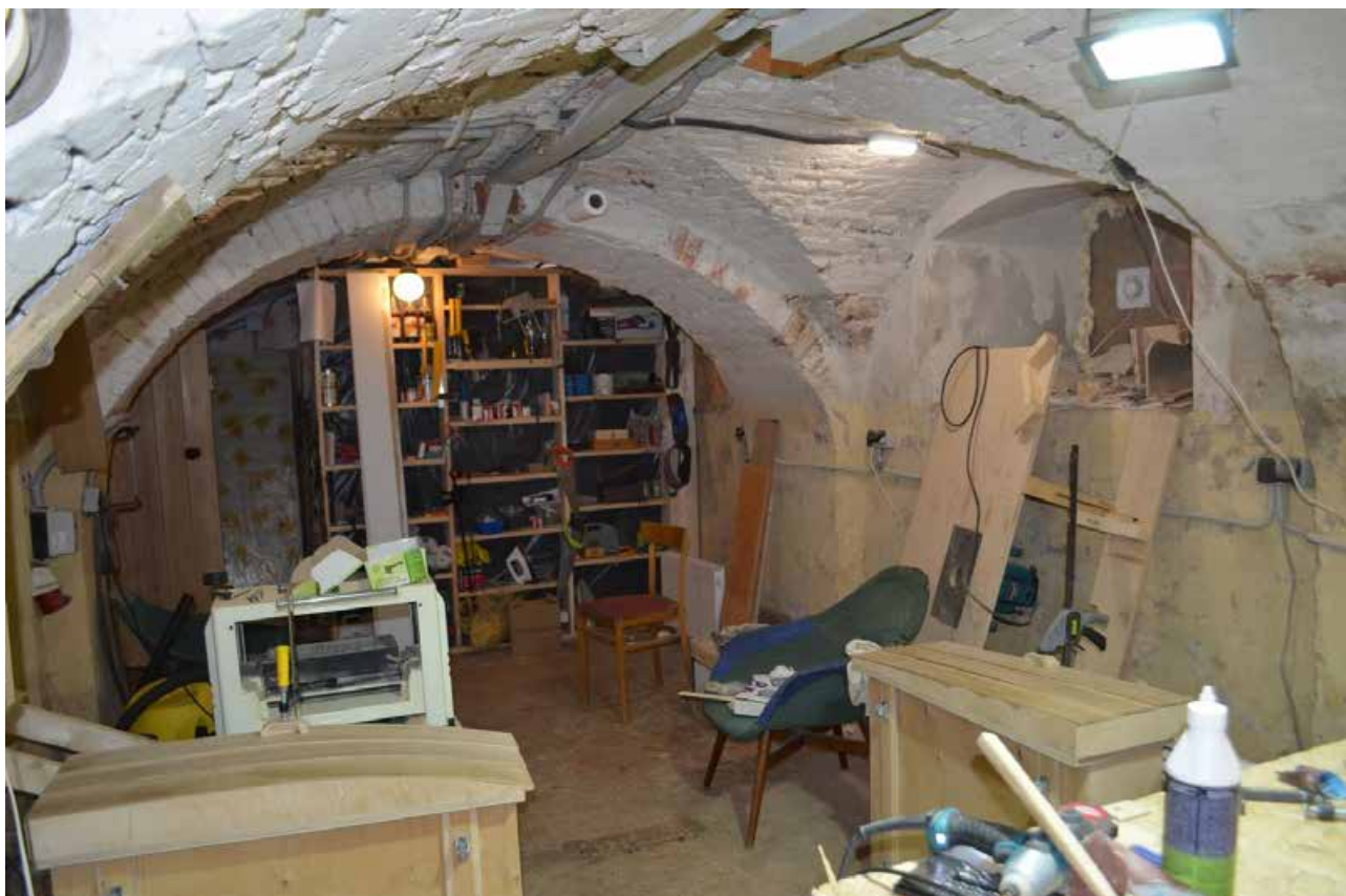
Фото 40. Объект культурного наследия федерального значения «Церковь лютеранская Воскресения Христова». Подвал. Помещение 2-Н (8). Фрагмент. Съёмка 31.10.2022 г.
