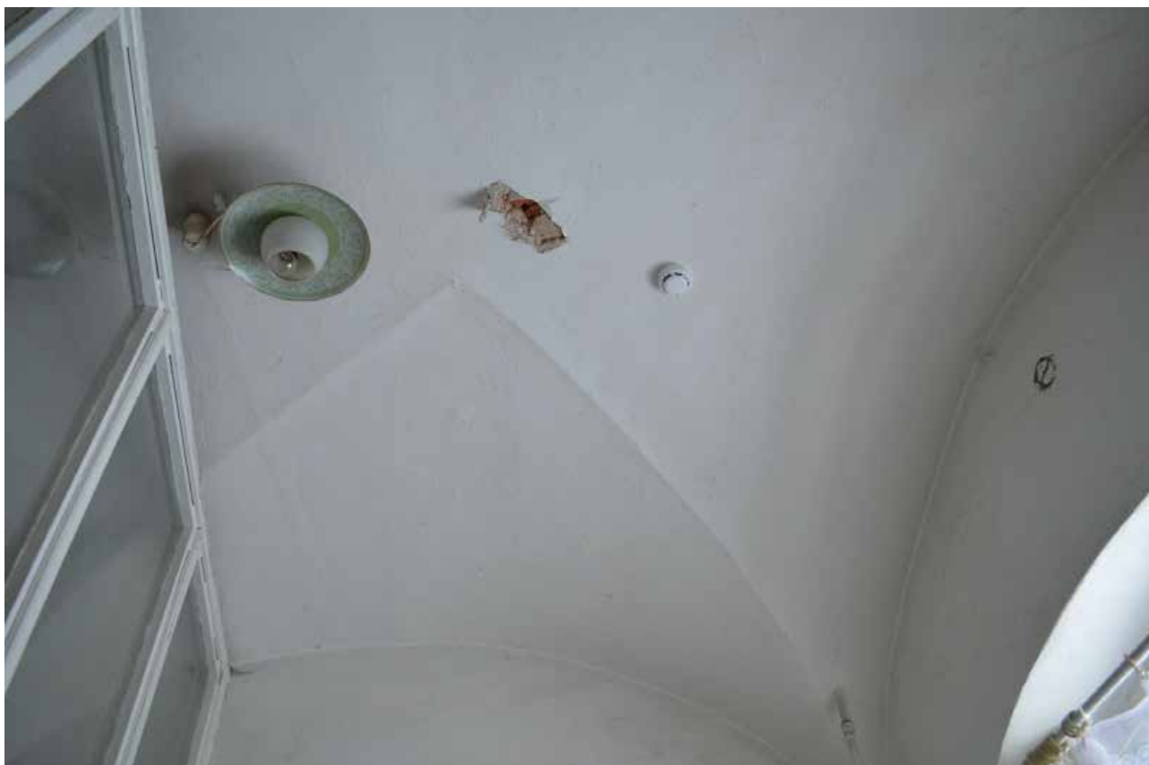
Фото 48. Объект культурного наследия федерального значения «Церковь лютеранская Воскресения Христова». Первый этаж. Помещение 1-Н (13). Фрагмент. Съёмка 31.10.2022 г.
