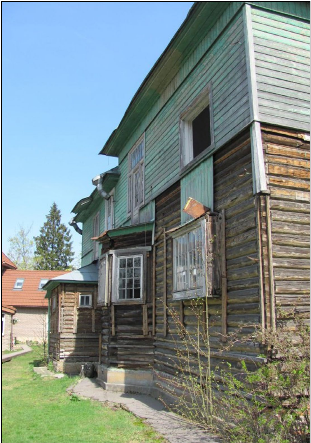
36. Западный фасад 2-х этажного здания. Общий вид. Фотография 2017 г. ООО «Студия архитектуры и дизайна профессора Горюнова «Арт Деко».
