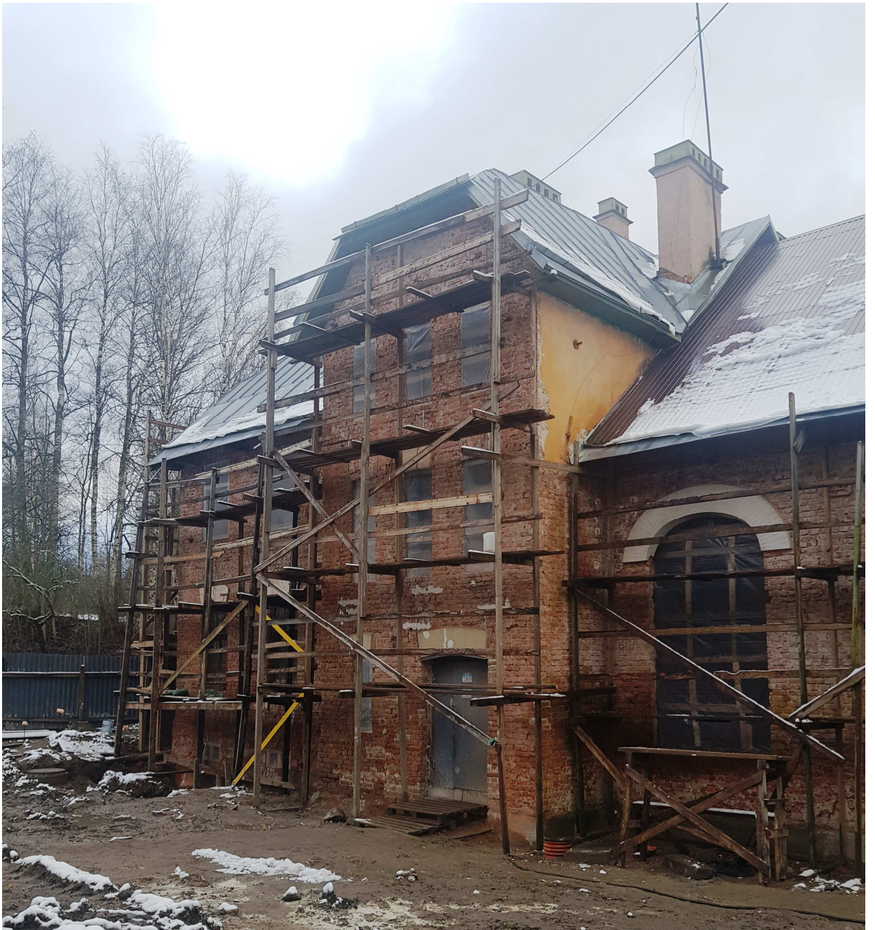
4. Главное здание (Подгорная ул.д.16, лит.А). Фрагмент продольного фасада (2-3-х-этажная часть здания). Вид с востока.
