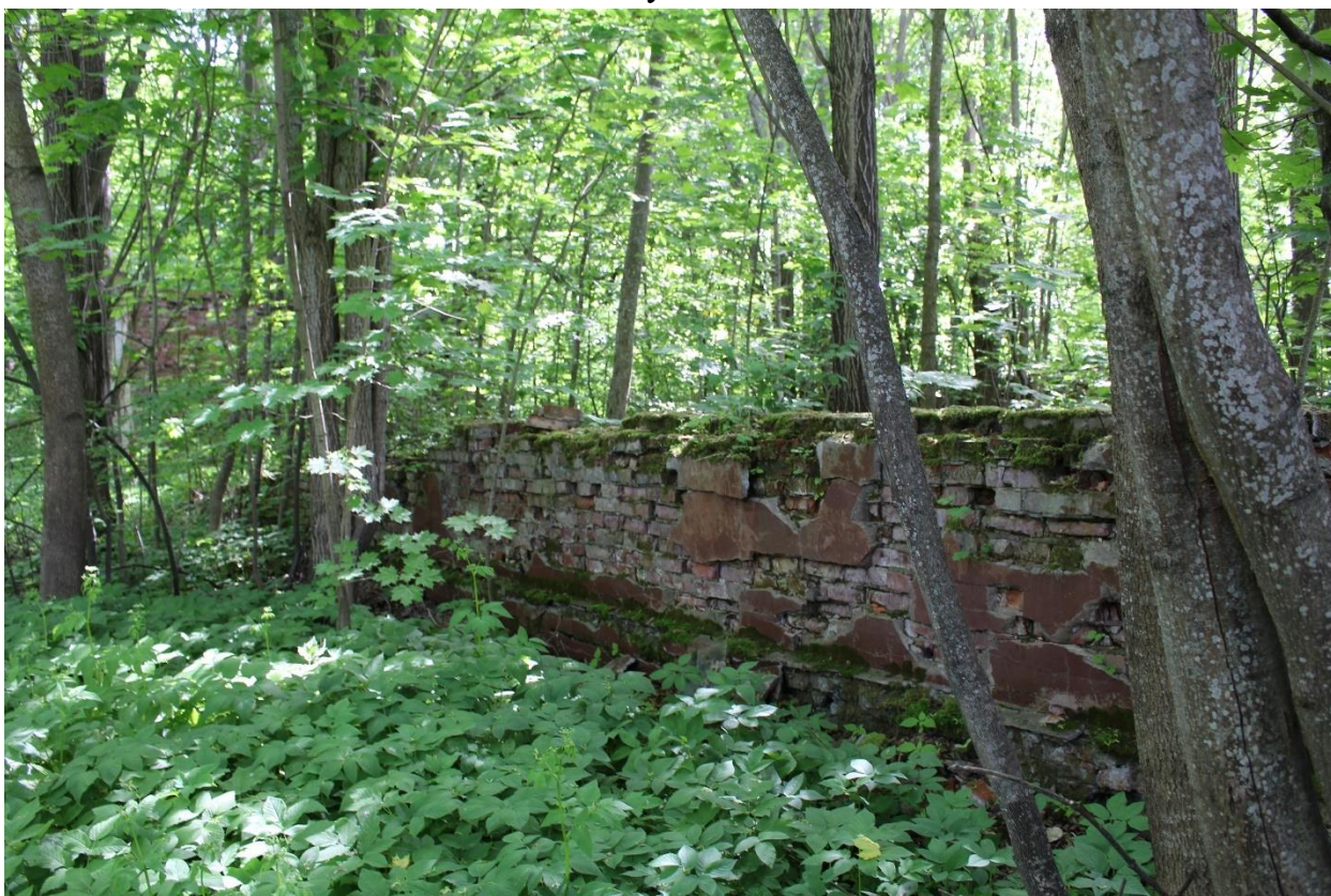
Фото 14. Вид на руины поздней (1964 г.) северной пристройки к основному объему здания.
