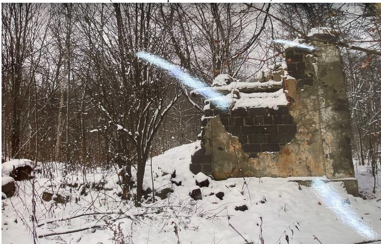
Илл. 24. Руины восточной части северной пристройки к зданию (источник: архив КГИОП 203Г-25).
