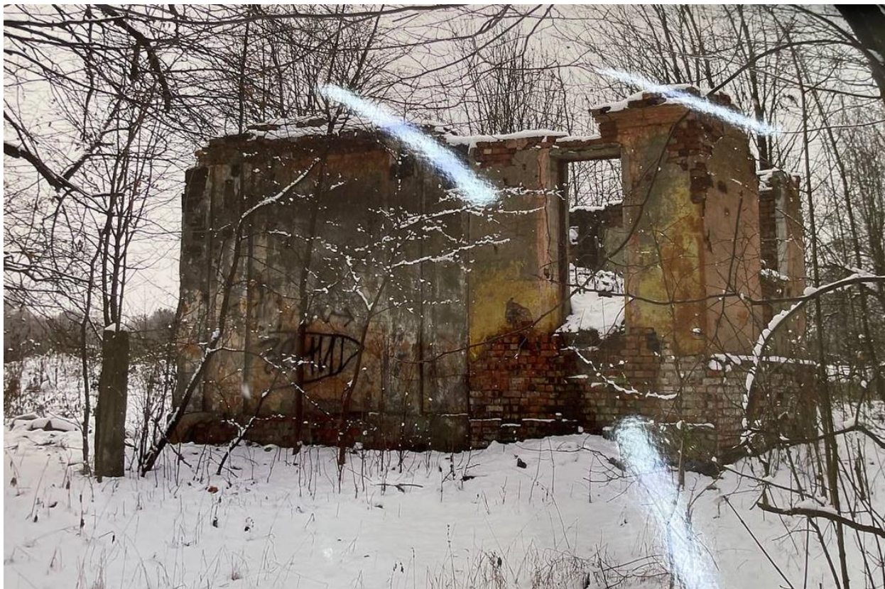
Илл. 23. Руины восточной части северной пристройки к зданию в 2008 году (источник: архив КГИОП 203Г-25).
