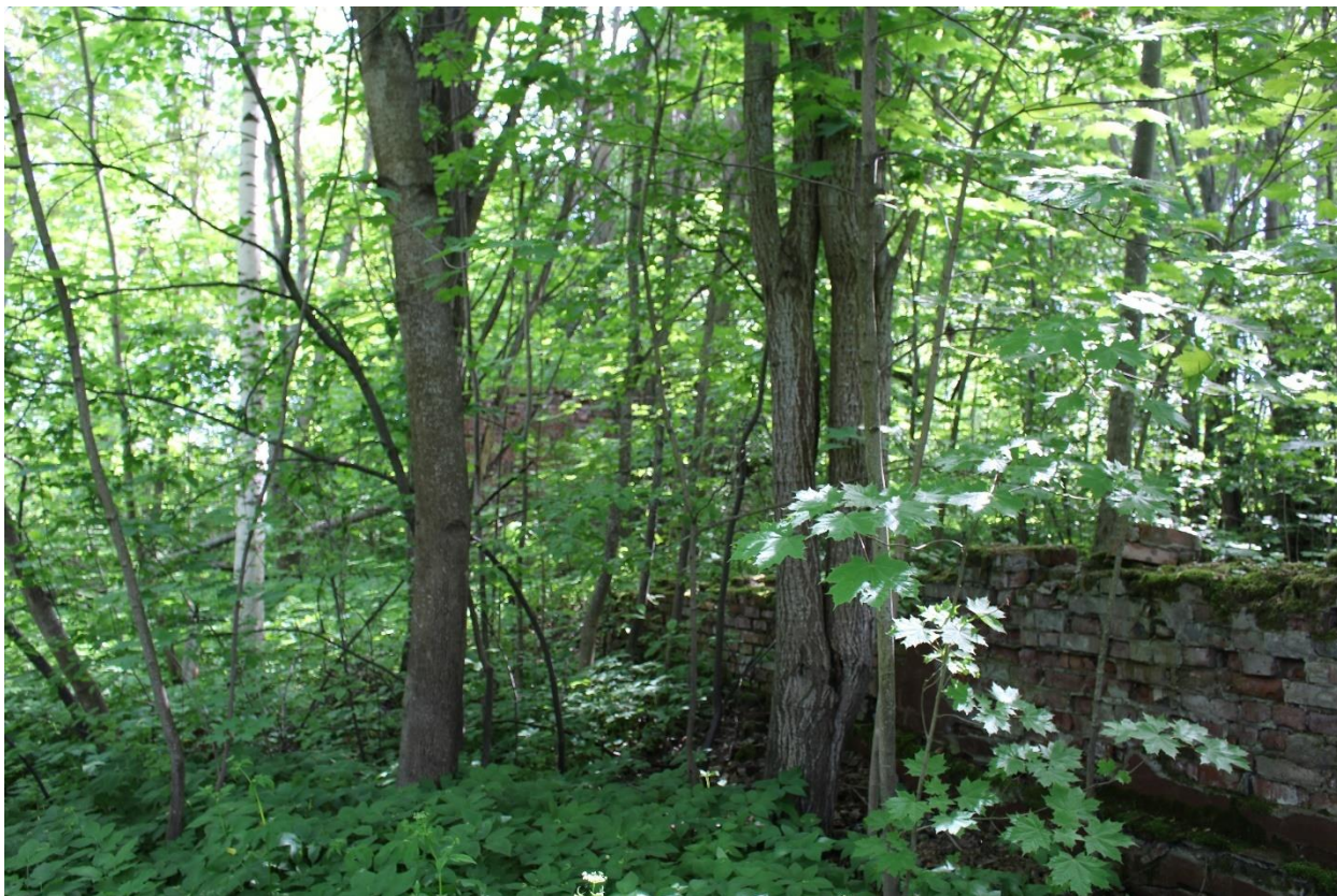
Фото 13. Вид на руины поздней (1964 г.) северной пристройки к основному объему здания.
