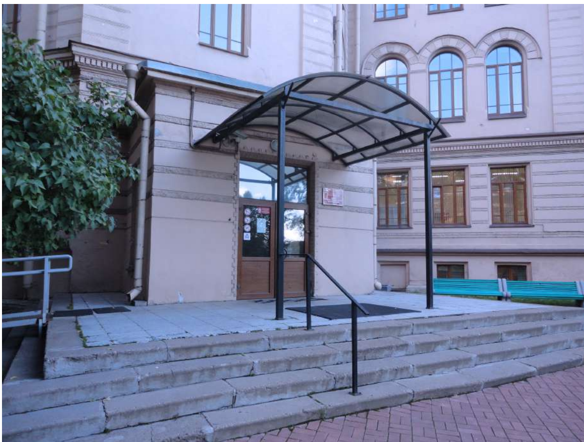
8. Участок по адресу: Санкт-Петербург, Арсенальная наб., 3; Комсомола ул., 4. Здание школы. Общий вид на козырек, крыльцо. 27.09.2021 г.
