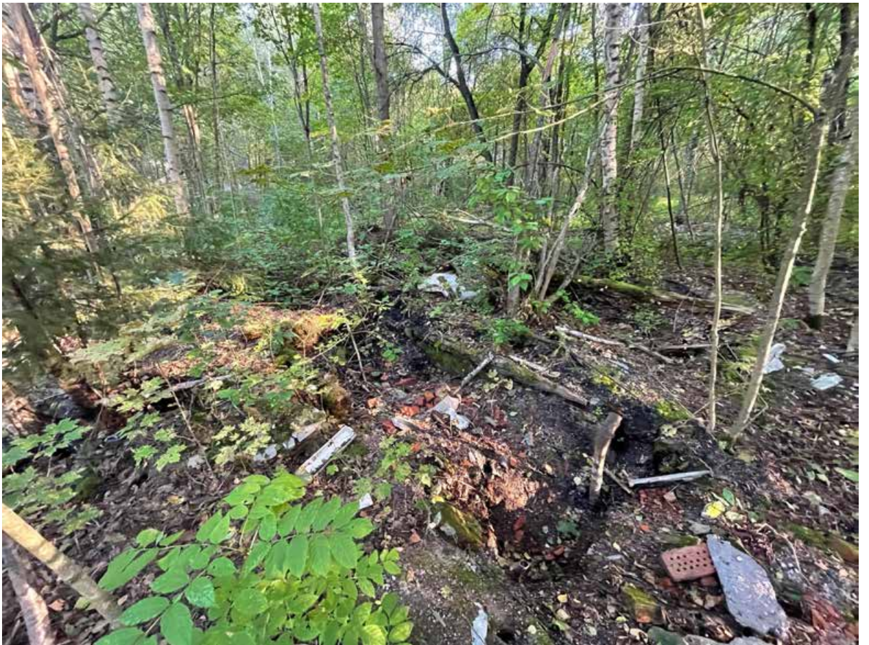
Фото 9. Остатки строительных конструкций здания по адресу: Санкт-Петербург, г. Зеленогорск, Театральная ул., д. 7.
